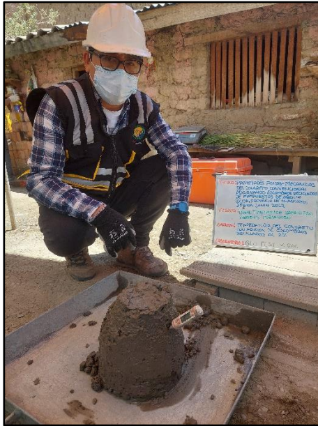
Fotografía N° 27: Medición de la temperatura del concreto saliendo de la mezcladora con 2% de escombros reciclado, según referencia de la norma NTP 339.184.
