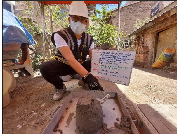
Fotografía N° 15: Medición de la temperatura del concreto saliendo de la mezcladora convencional, según referencia de la norma NTP 339.184.
