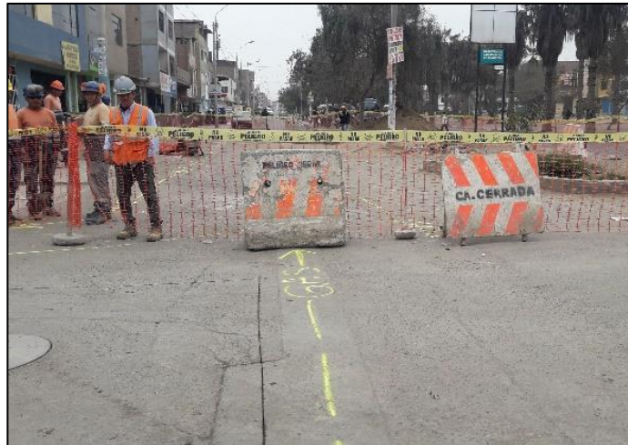
Figura 40 Señalización de interferencia
