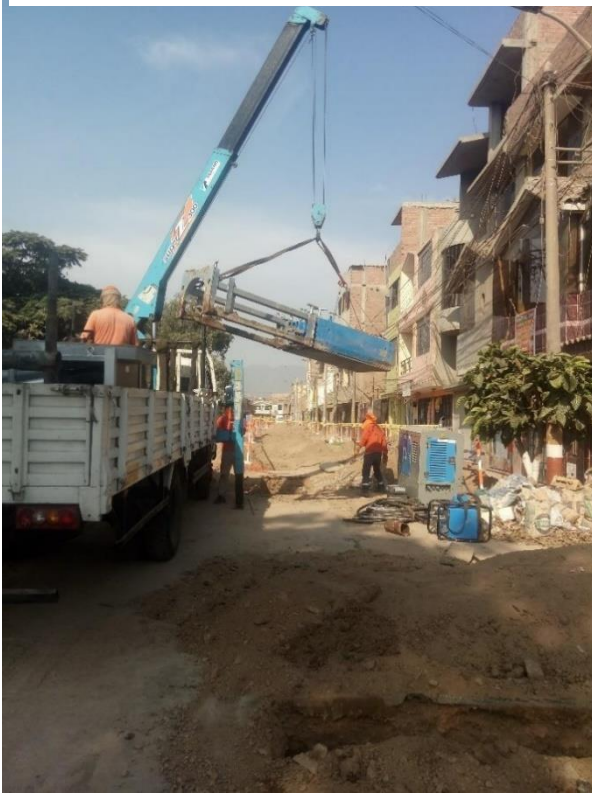
Figura 45 Traslado de equipo Cracking
