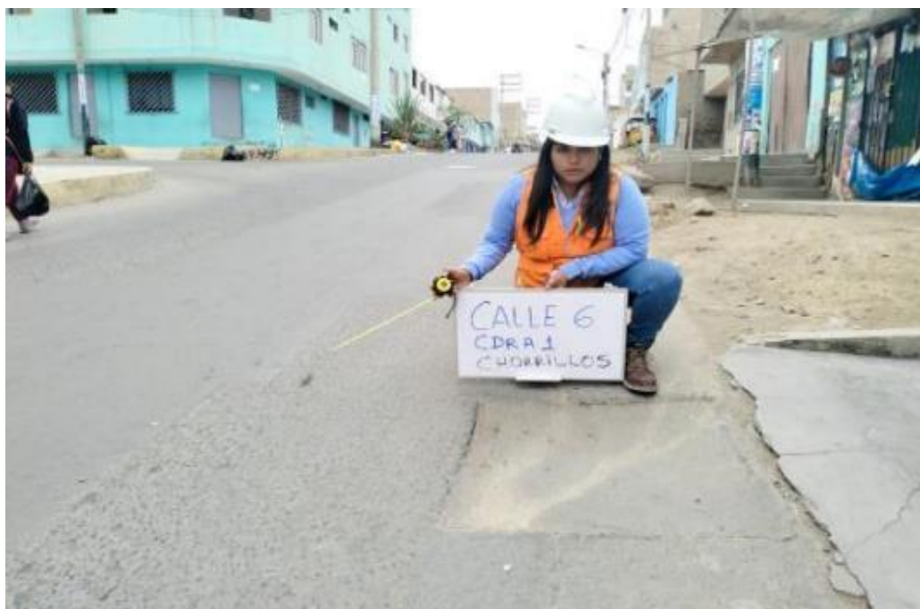
Foto N° 12.- Se observan brechas(huecos) con una profundidad de 4cm, largo 0.80cm y ancho de 0,60cm.
