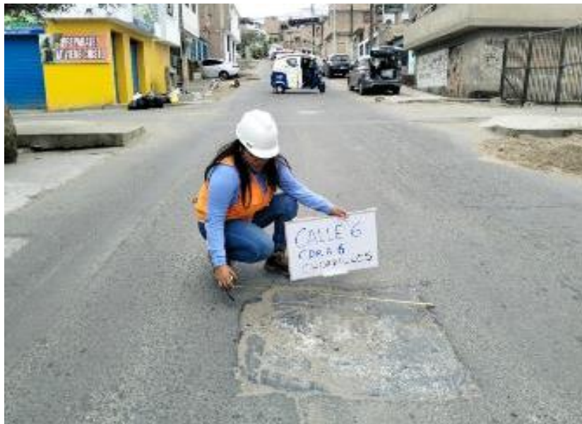
Figura 12. Hundimiento en el pavimento Fuente: Elaboración propia
