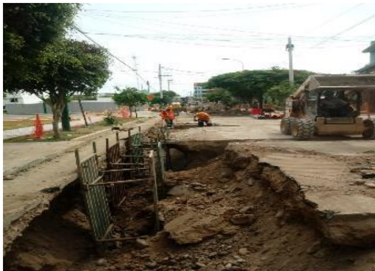
Figura 1. Se observa la sobre excavación que como consecuencia origina asentamiento.
