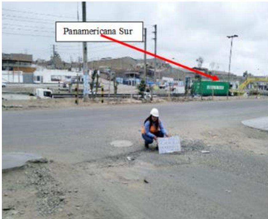
Figura 13. Hundimiento en el pavimento Fuente: Elaboración propia
