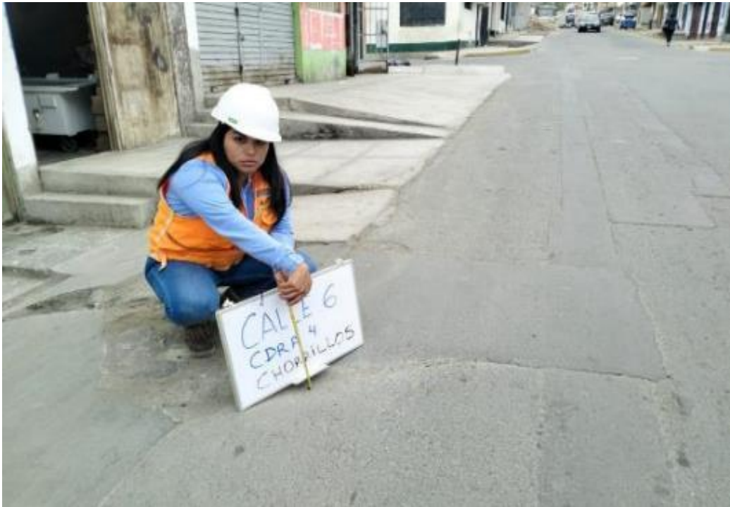
Foto N° 10.- Se observan asentamiento de 2.40cm, ubicado en la cuadra 6.
