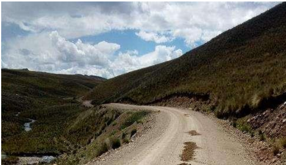
Figura No 02: Evidencia de deterioro de la vía.
