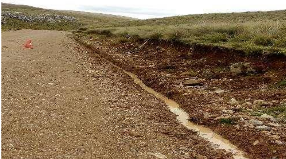
Figura No 04: Cunetas obstruidas por cúmulos de tierra.
