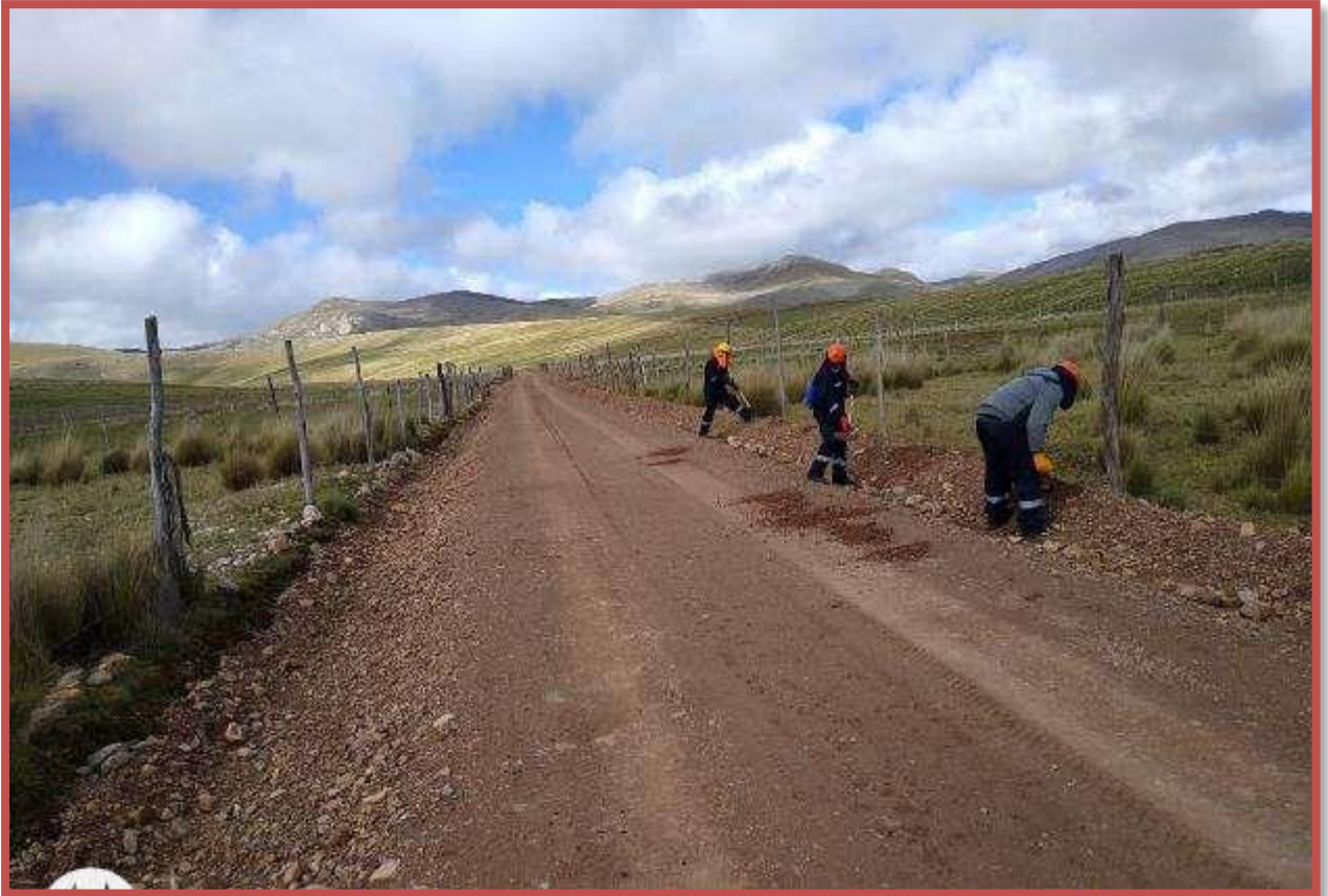
07. SE OBSERVA EL BACHEO
