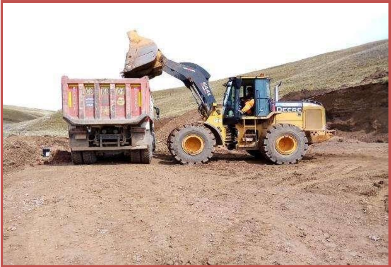
03. SE OBSERVA EL CARGADO DEL MATERIAL DE CANTERA PARA MEJORAMIENTO DE SUB-RASANTE
