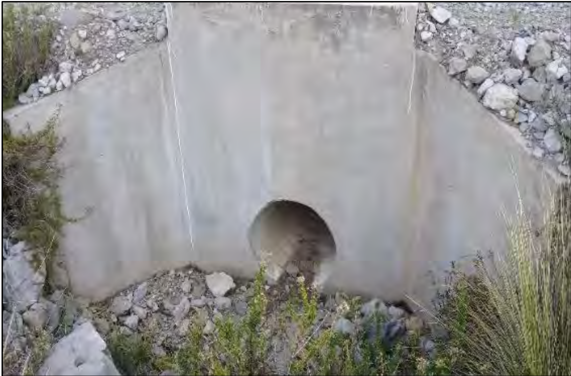
Fotografía 19. Alcantarilla tipo marco.
