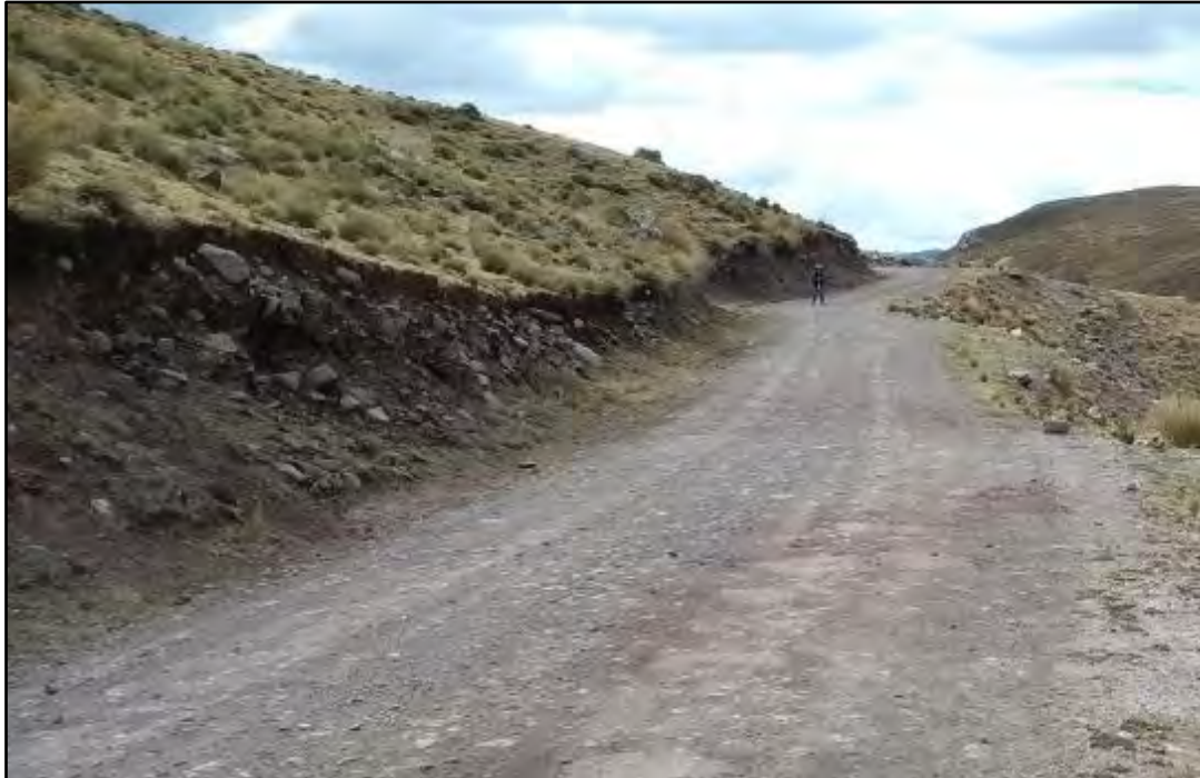
Fotografía 15. Vista de la vía con falta de mantenimiento.
