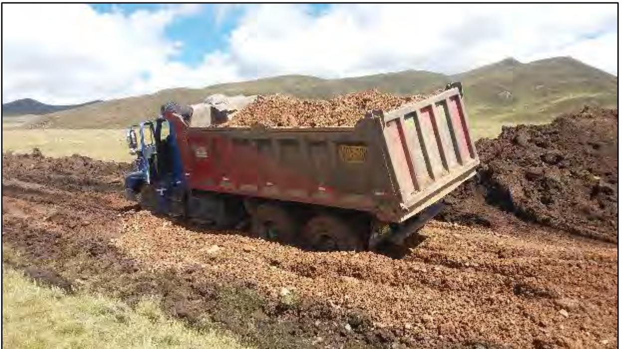
Fotografía 14. Vista de dificultades al transportar el material en la zona que se realizó la apertura de vía. Progresiva 15+200.
