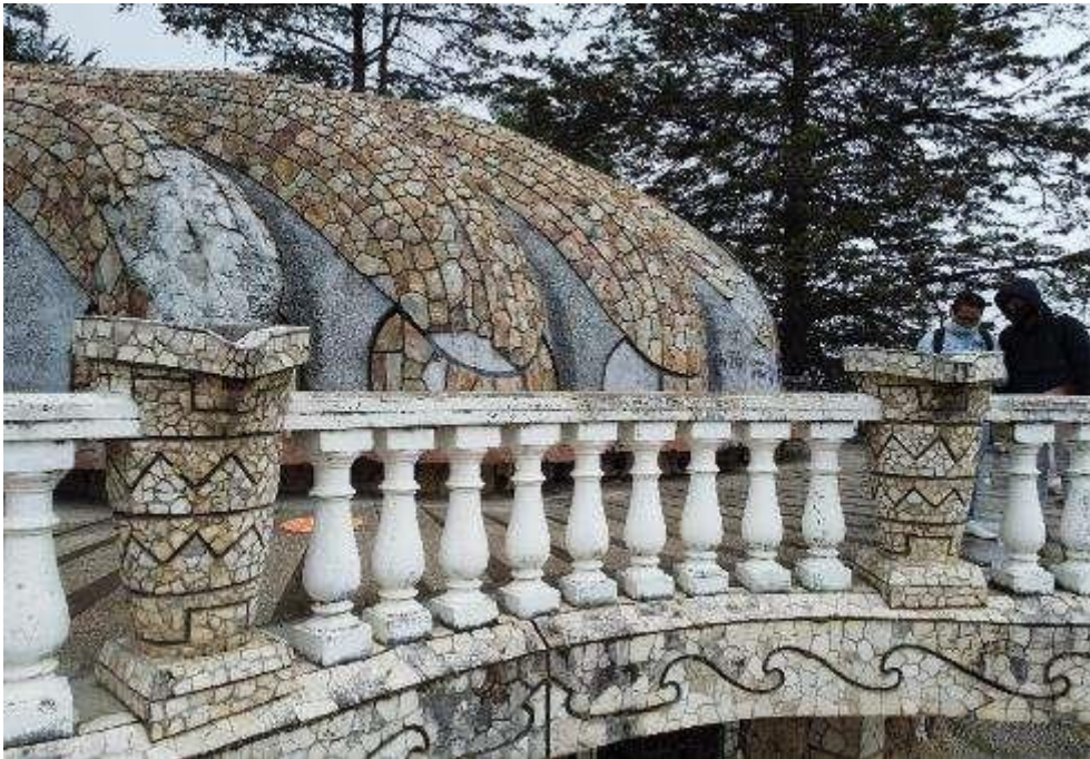
Mal estado de la concha acústica.
