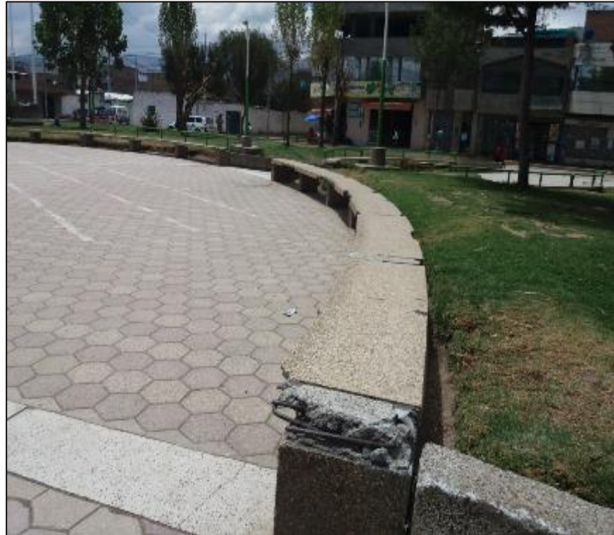
Figura N° 27: Desprendimiento de materiales de las bancas
