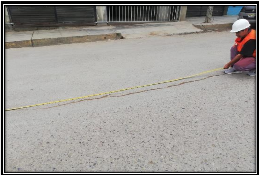
Foto N°4: Se evidencia la presencia de fallas longitudinales con un grado de severidad medio.
