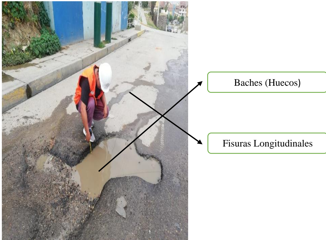
Figura 5. Se visualiza las fallas longitudinales y baches
