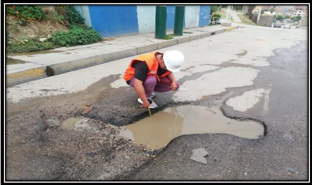
Foto N°1: Se evidencia la presencia de baches y huecos con un grado de severidad elevado.
