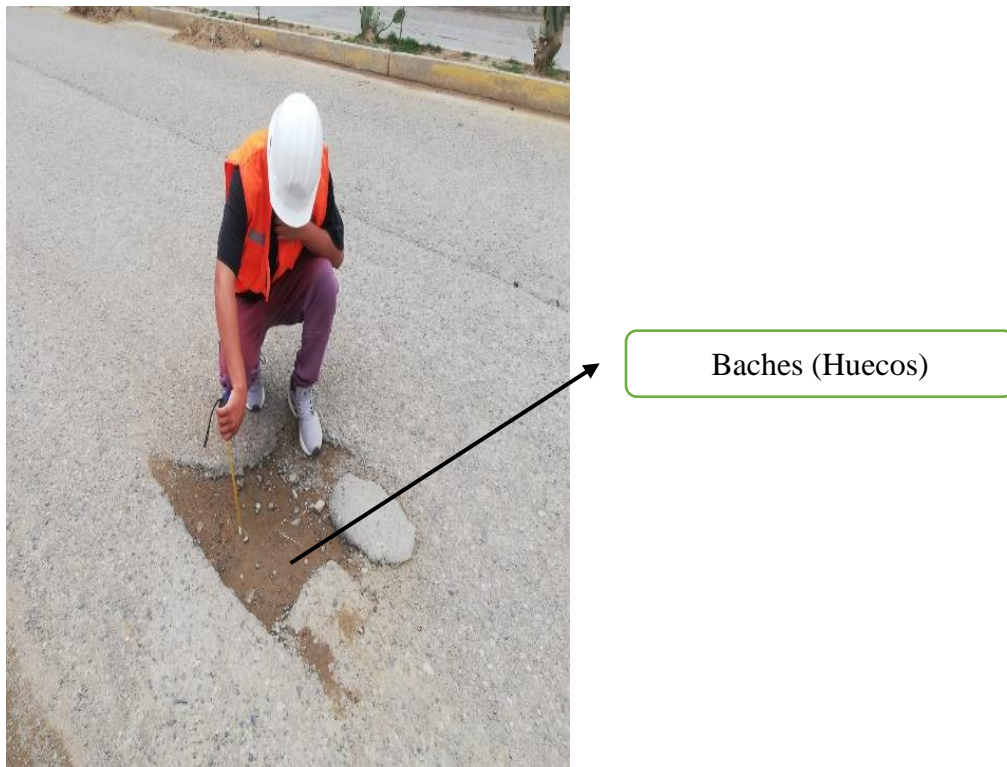
Figura 16. Se visualiza la falla baches (huecos)
