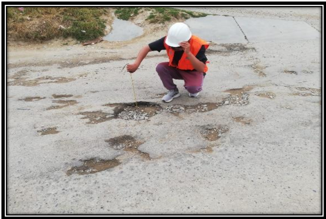
Foto N°8: Se evidencia la presencia de baches y piel de cocodrilo con grado de severidad alto.
