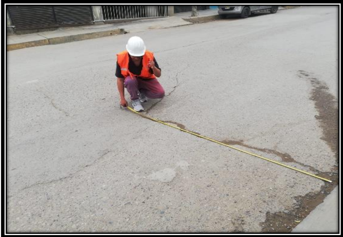
Foto N°3: Se evidencia la presencia de fallas transversales con un grado de severidad medio.
