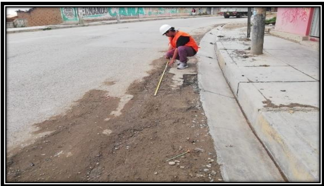
Foto N°2: Se evidencia la presencia de ahuellamiento y baches con un grado de severidad elevado.
