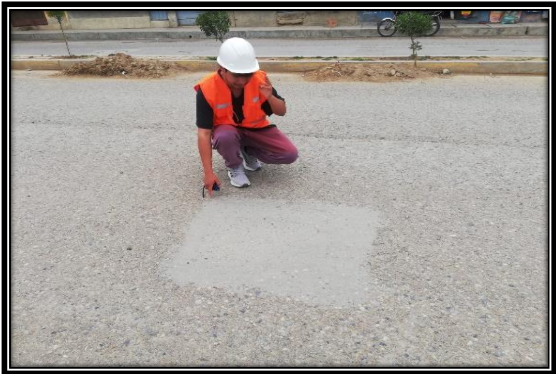
Foto N°6: Se evidencia la presencia de parcheo con un grado de severidad bajo.
