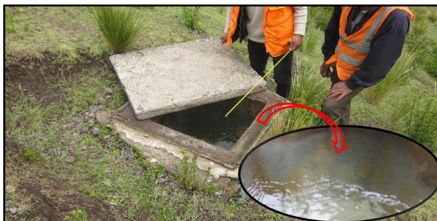
Figura 5.3 Cámara Rompe Presión Tipo VI -01
