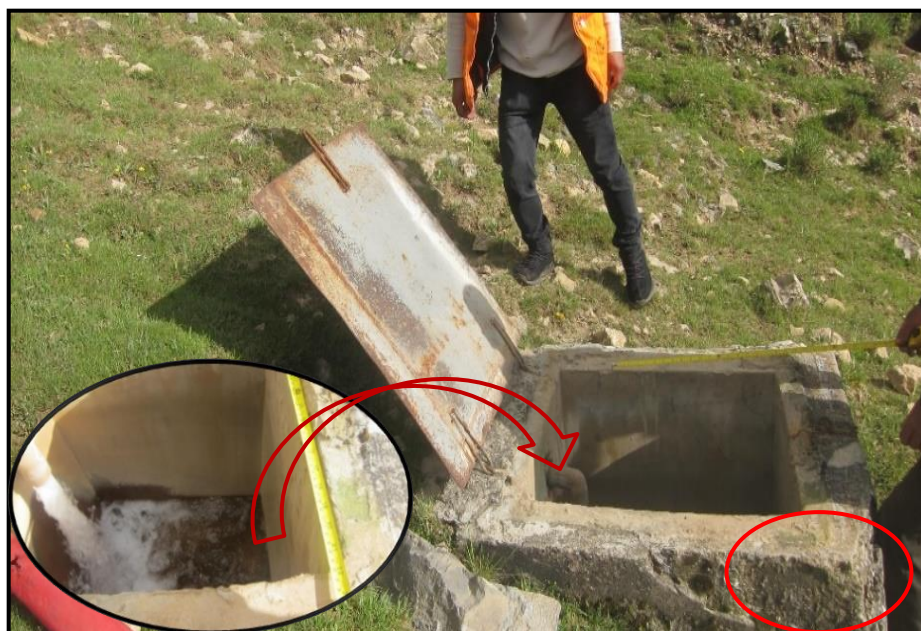
Figura 5.12 Cámara Rompe Presión Tipo VI - 10
