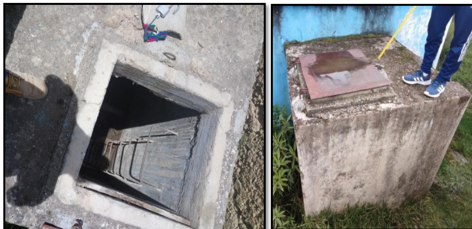
Figura 5.14 Cámara De Válvulas Del Reservorio Existente
