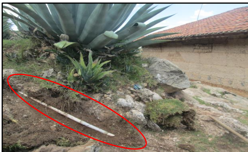
Figura 5.17 Tubería expuesta en Red de Distribución
