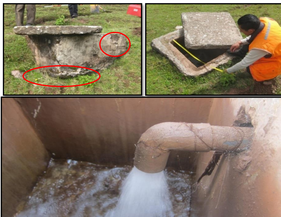
Figura 5.8 Cámara Rompe Presión Tipo VI - 06
