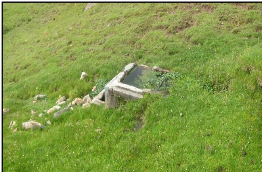
Figura 5.10 Cámara Rompe Presión Tipo VI - 08
