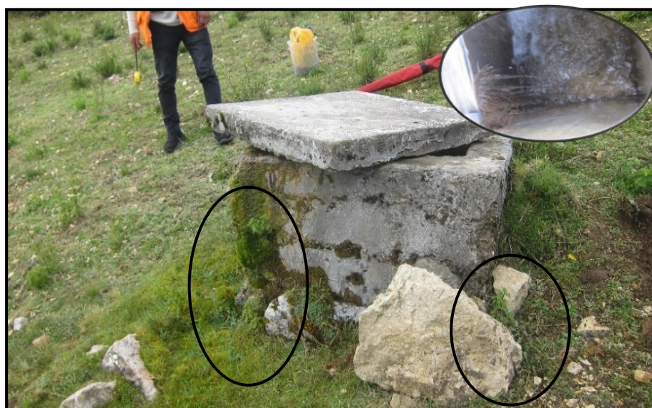
Figura 5.7 Cámara Rompe Presión Tipo VI - 05
