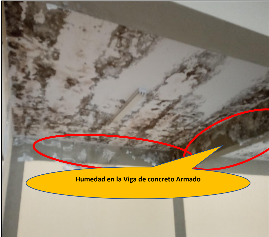
Figura 73 Humedad en viga peraltada de concreto armado
