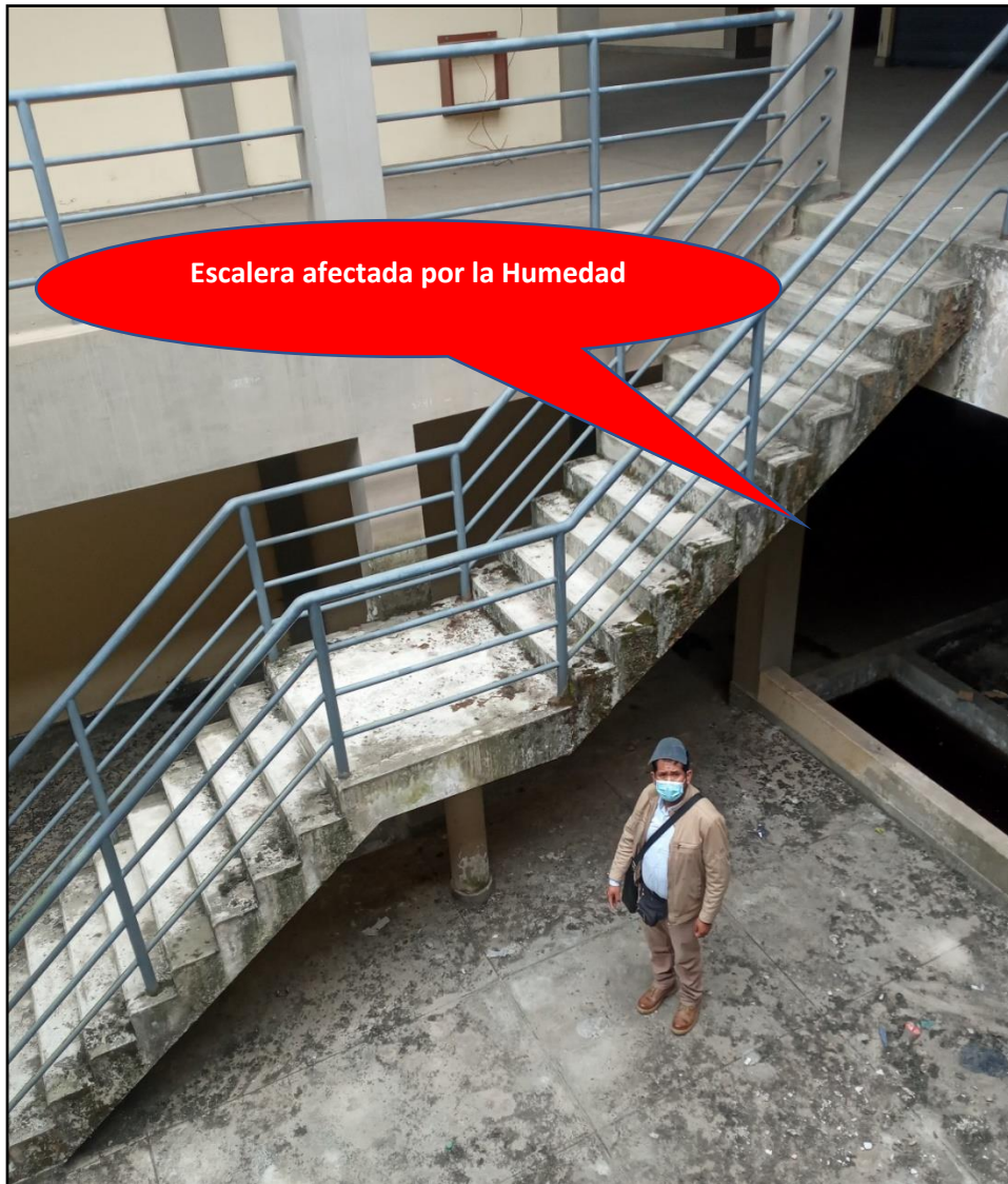
Figura 75 Escalera afectada por la humedad
