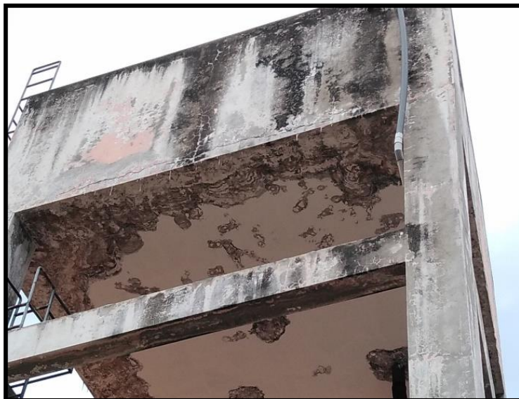
Figura 5 Humedad en la estructura
