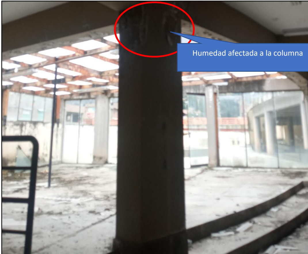
Figura 72 Columna afectada por la humedad
