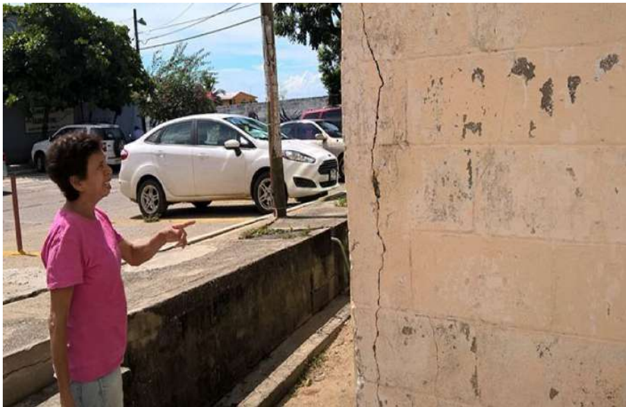
Figura 2. Baja resistencia del concreto
