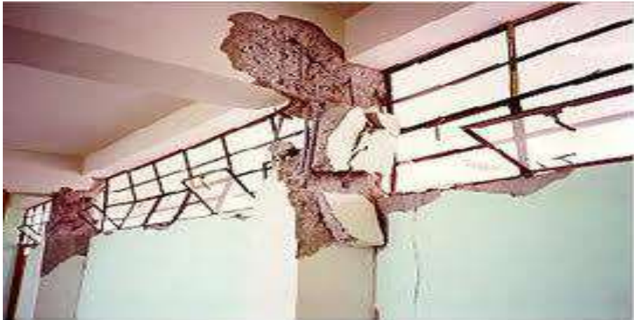
Figura 1. Fallas estructurales en las edificaciones
