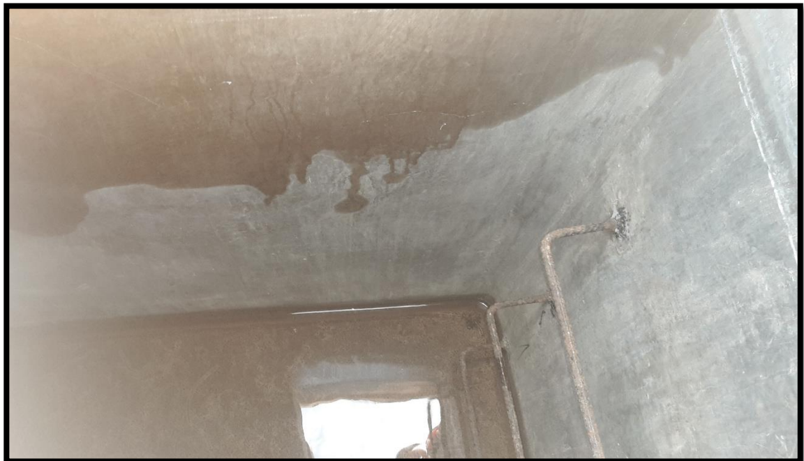
Fotografía N° 06. Se observa el mal estado del reservorio.
