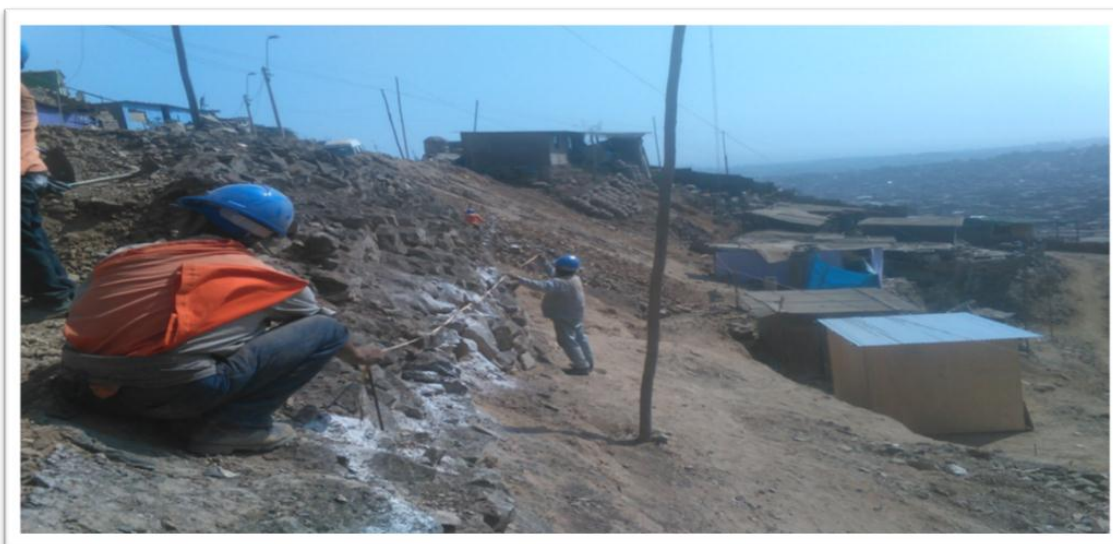
Figura 2 Construyendo viviendas inadecuadas sin ningún criterio Técnico, convirtiéndose en zonas de alto riesgo no apta para habitar
