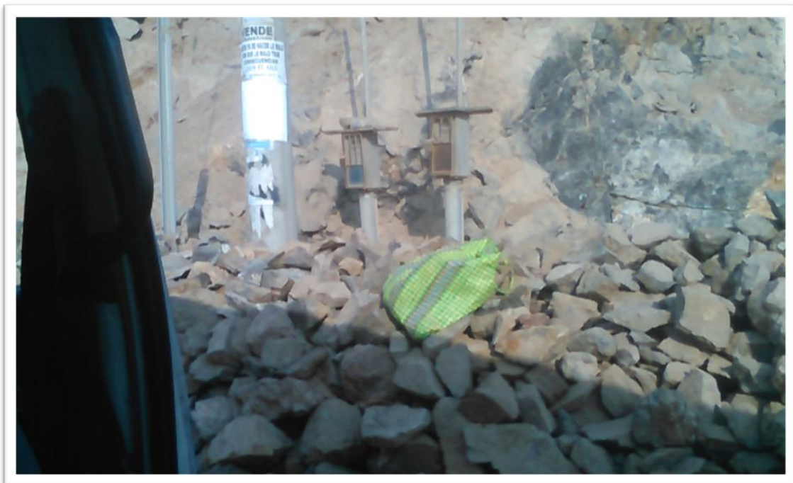
Figura 4 De igual manera los servicios de agua, luz, desagües, en el proyecto se observa filtraciones de agua por tuberías rotas de agua, suelos removidos por la humedad.
