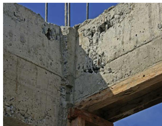
Fotografía 5. Cangrejeras en el concreto. Se producen típicamente por falta de vibrado.
