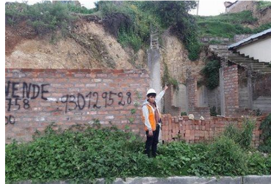
Fotografía 3. Abandono del proceso constructivo y deterioro de los materiales.
