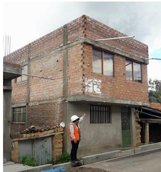
Fotografía 4. Construcción con ladrillo pandereta no son apropiados para la construcción de muros portantes por su poca resistencia.
