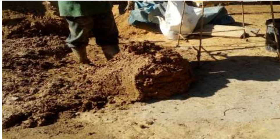
Figura 55. Proceso de mezclado manual con protección en pies y manos FUENTE: Imagen Propia
