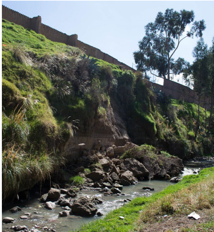
Figura N° 14: Falta de cuidado del borde del río Shullcas. Fuente: Propia del autor
