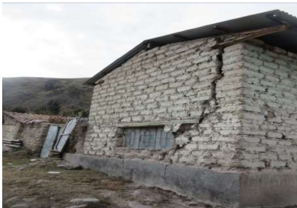
Fig. N° 1-1 Grieta del adobe en las casas de Acopalca
