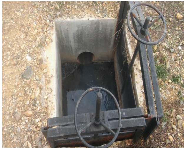
IMAGEN 18: Se aprecia las cajas de control sin su debido mantenimiento.
