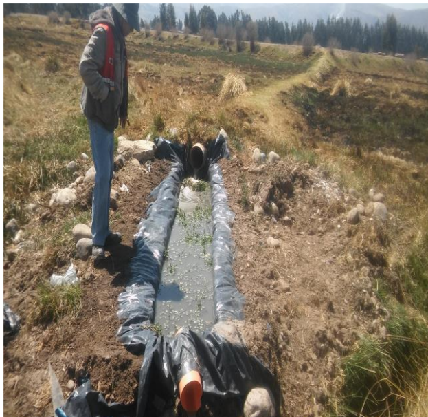
IMAGEN 14: En la imagen se muestra ya en uso la Implementación de Filtros Verdes.
