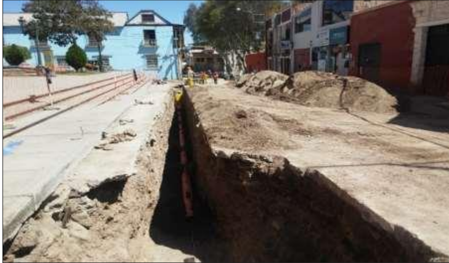
Figura N° 17: Tendido de tubería de la red de alcantarillado de la Ca. Ayacucho.
