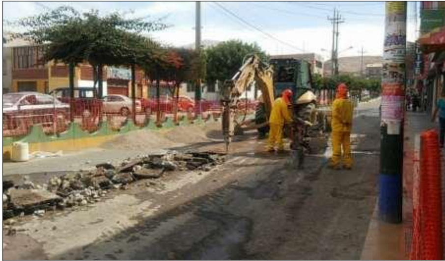
Figura N° 15: Rotura de pavimento Av. Balta – lado derecho.
