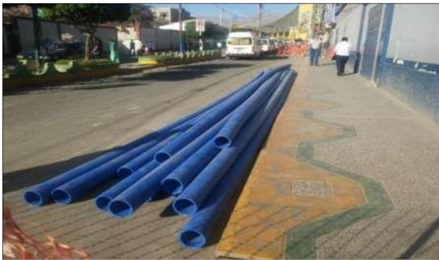
Figura N° 8: Tubería HDPE de Ø160mm.
