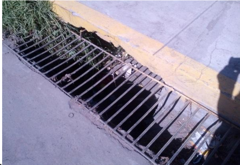
Fotografía 11. Deficiente estado del sistema de drenaje pluvial en la avenida Giráldez.
