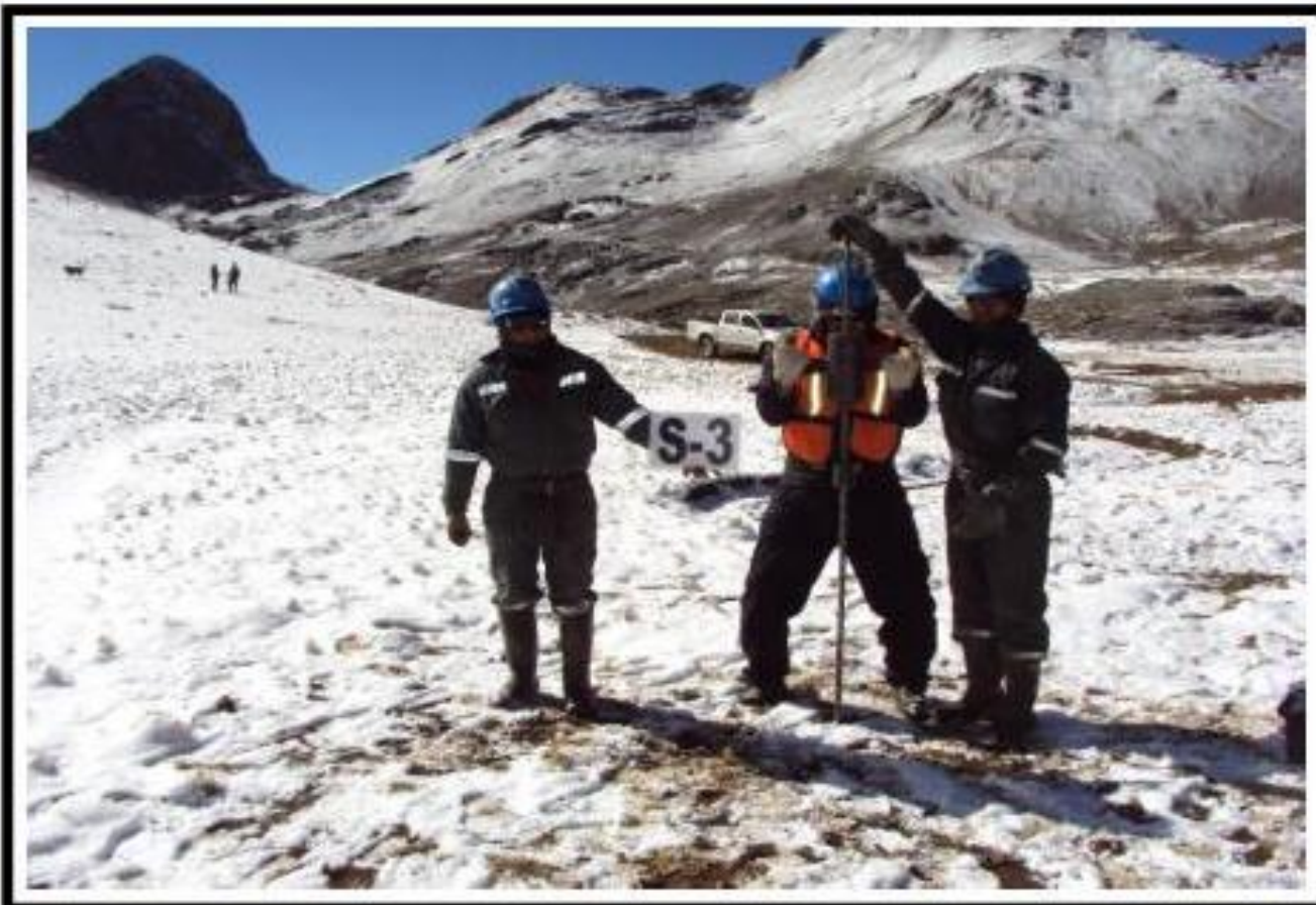
Fotografía 03 : Vista Mostrando el Sondaje (S-3), Realizado con Equipo de Penetración Dinámico (Cono de Peck) en la Cimentación de Depósito de Relaves "SANSIL" – Primera Etapa.
