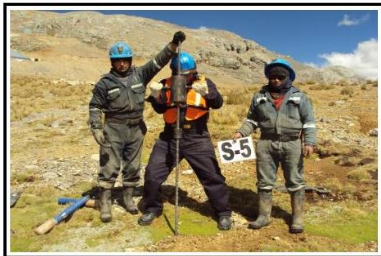
Fotografía 06 : Vista Mostrando el Sondaje (S-5), Realizado con Equipo de Penetración Dinámico (Cono de Peck) en la Cimentación de Depósito de Relaves "SANSIL" – Primera Etapa.
