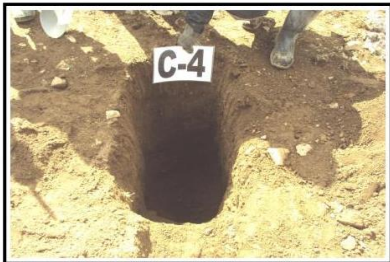
Fotografía 05 : Vista Interior de la Calicata (C-4), Realizada en la Cimentación de Depósito de Relaves "SANSIL" – Primera Etapa. Se Puede Aprender en las Paredes y Fondo de la Excavación el Subsuelo Constituido por Suelo Coluvial que Clasifica como Arena Arcillo Limosa con Grava (SM-SC).
