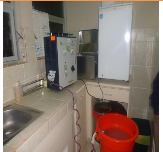
Producción de solución de hipoclorito al 0.5% en la microred de Surcubamba – Tayacaja
