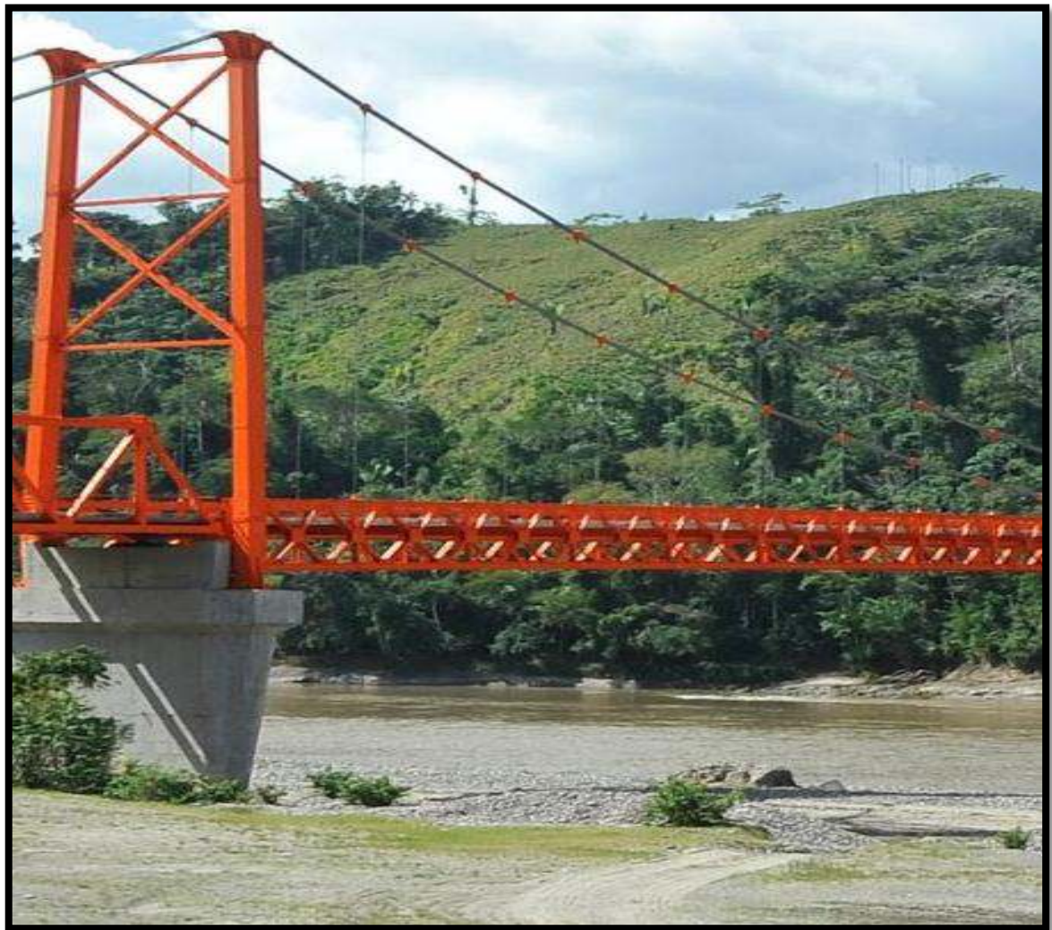
FIGURA N° 2.13: Separación de péndolas, puente punta arenas, puente colgante Fabricado por la empresa a Austriaca Waagner Biro, sobre el rio Huallaga en la provincia de Mariscal Cáceres, región San Martin.
