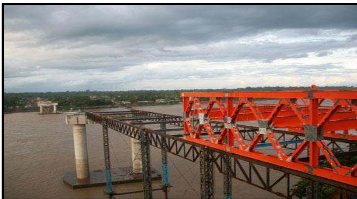
FIGURA N° 2.6: Sección transversal de la viga de rigidez reticulada, del puente continental, ubicado en Puerto Maldonado, que une Perú y Brasil, Fabricado por la empresa Austriaca Waagner Biro.
