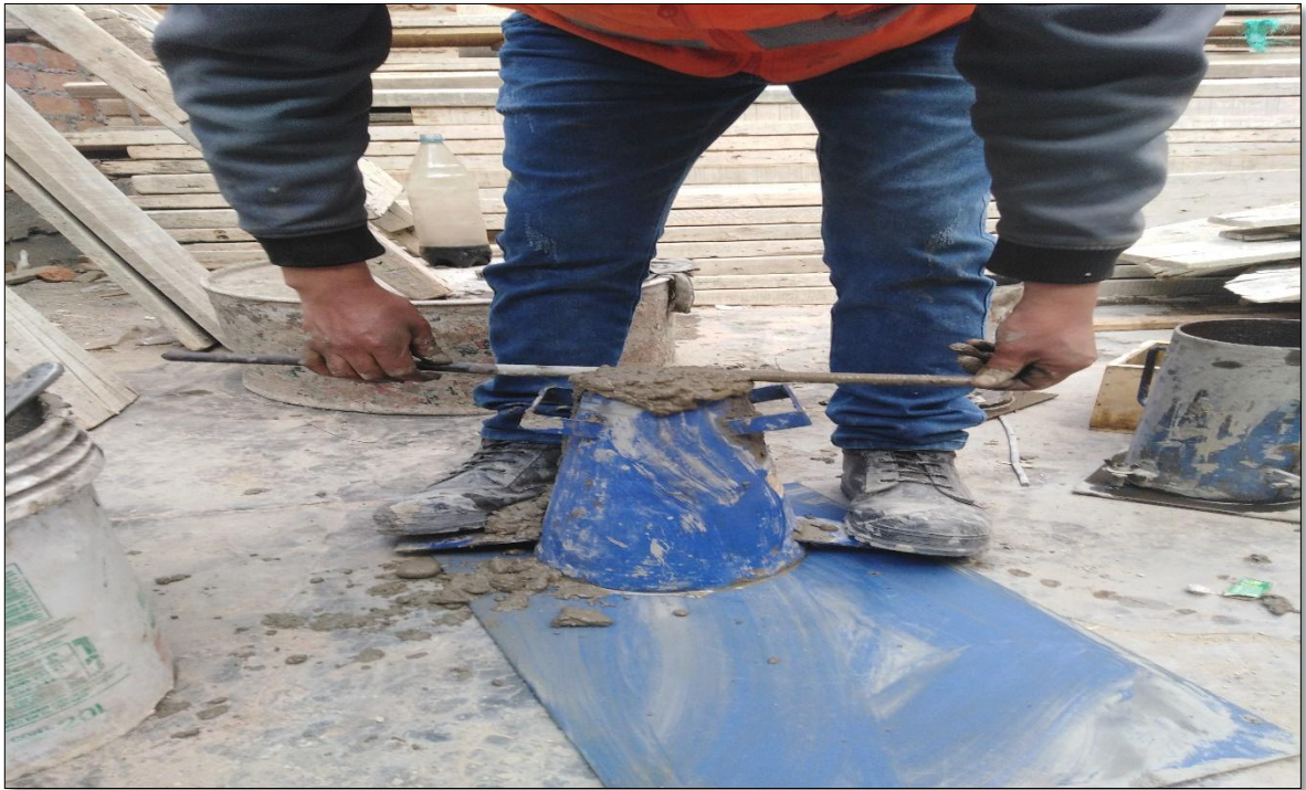
Fotografía 25. Se puede ver el enrasado final del cono con la varilla lisa para posteriormente realizar la medición del Slump
