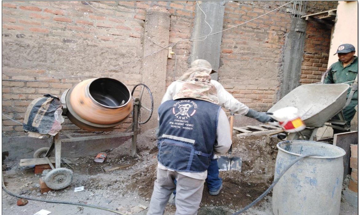
Fotografía 2. Podemos apreciar la elaboración del concreto con la ayuda de una mezcladora tipo trompo y teniendo como material predominante al hormigón.
