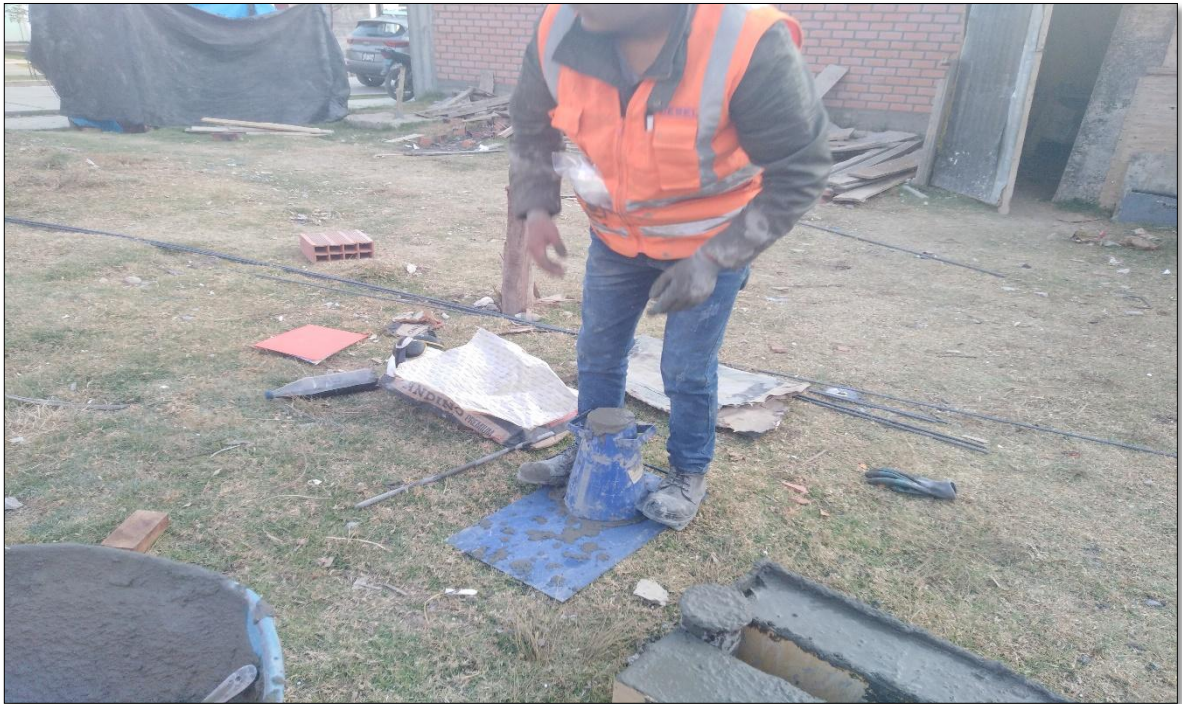
Fotografía 15. Se puede apreciar el procedimiento de ensayo para obtener el Slump de la muestra C, para cumplir con el indicador de este ensayo fue necesario contar con los equipos del ensayo de Asentamiento.
