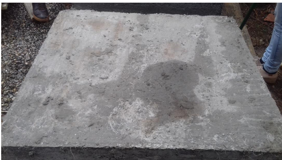
Fotografía 27. Sin presencia de fisuras en losa aligerada con adición de fibra de maguey.
