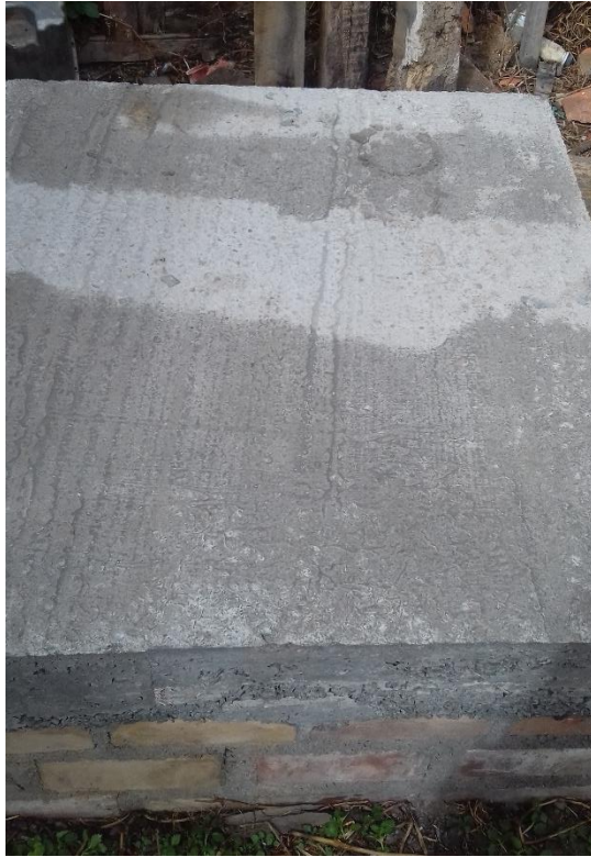
Fotografía 28. Sin presencia de fisuras en losa aligerada con adición de jugo de maguey.
