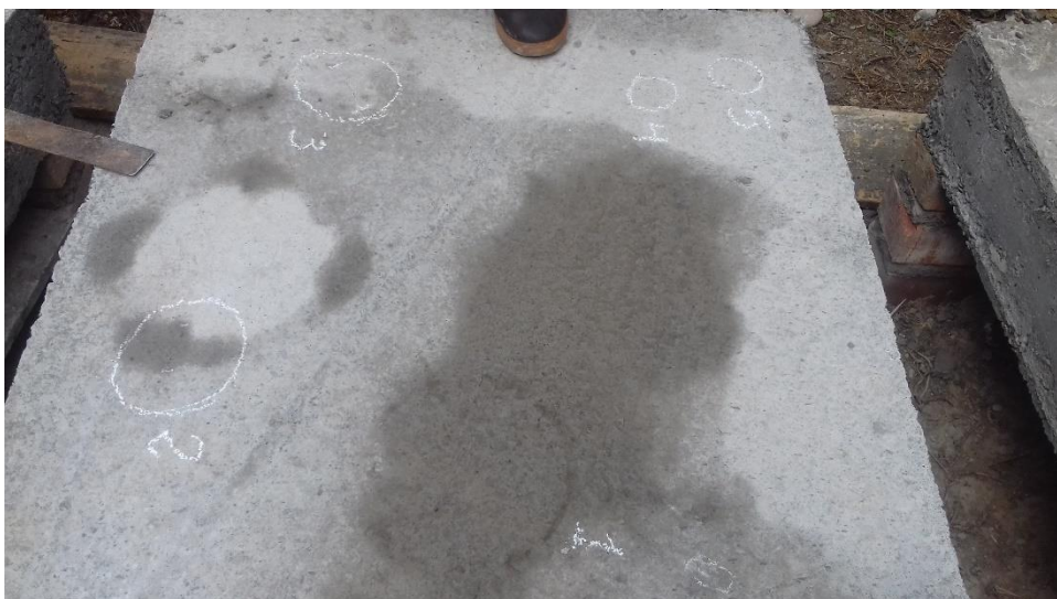
Fotografía 24. Identificación de fisuras en la losa aligerada convencional.
