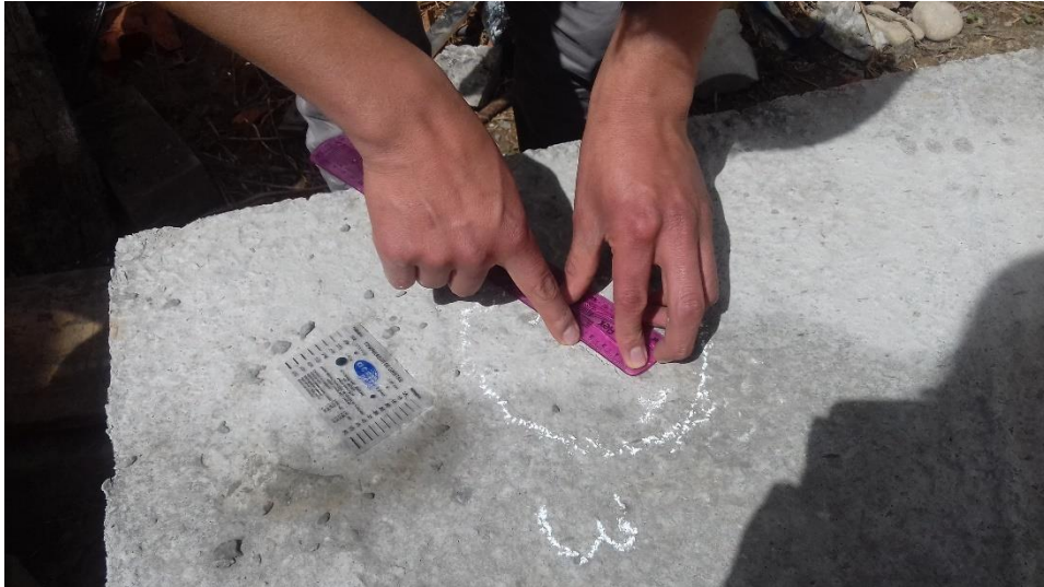
Fotografía 25. Medición de la fisura N°3 en la losa aligerada convencional.
