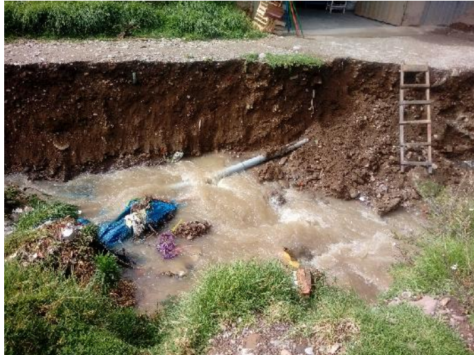
Figura 4: Derrumbes a causa de las fuertes precipitaciones y máximas avenidas.
