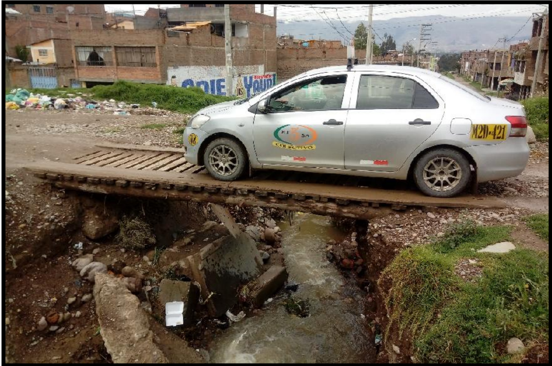
Foto N° 07: Se observa la situación actual en que se encuentra la Vía Flor de Mayo entre la Avenida Huancavelica.
