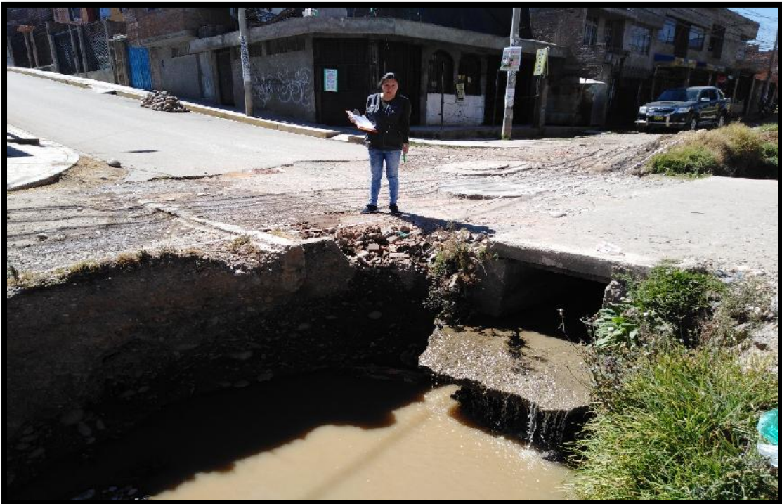
Foto N° 06: Se observa deslizamiento de tierra en el Canal.
