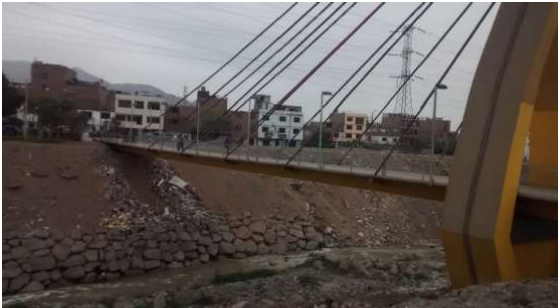
Falta de control en el rio Rímac. – Fuente propia.
