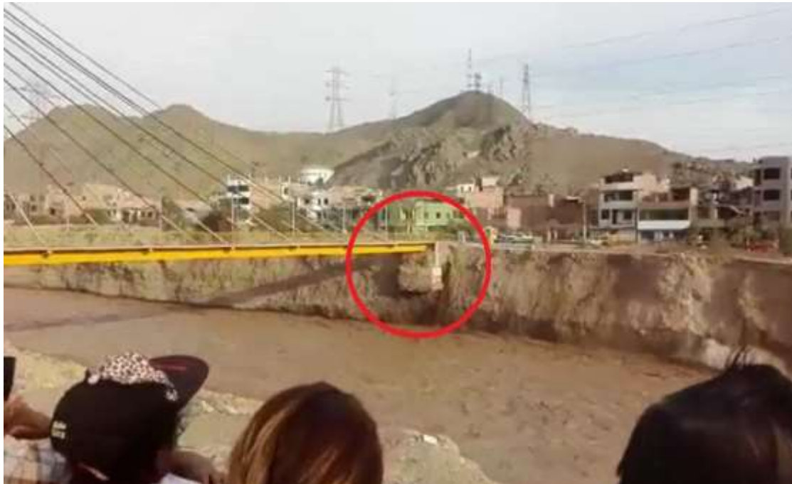
Vista del socavamiento en el puente talavera – Fuente propia.
