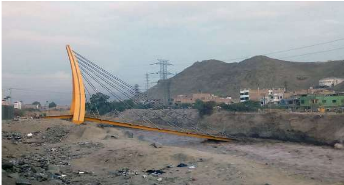
Vista de desplome de puente Talavera – Fuente propia.
