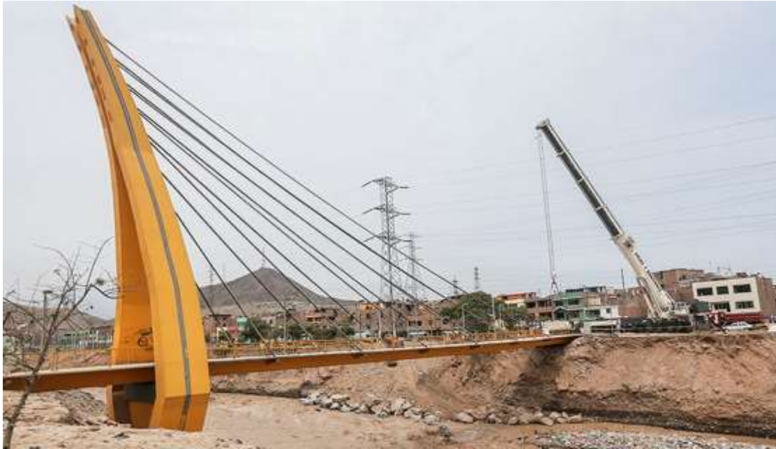
Vista del socavamiento en el puente talavera – Fuente propia.
