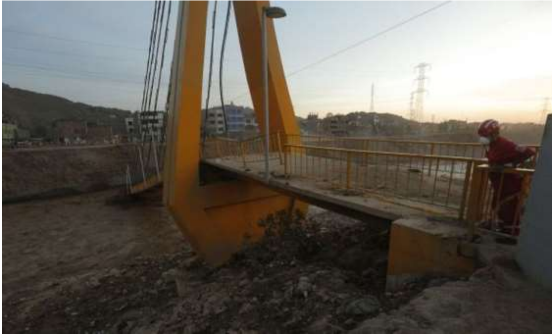
Socavamiento de puente Talavera de ambos extremos – Fuente propia.
