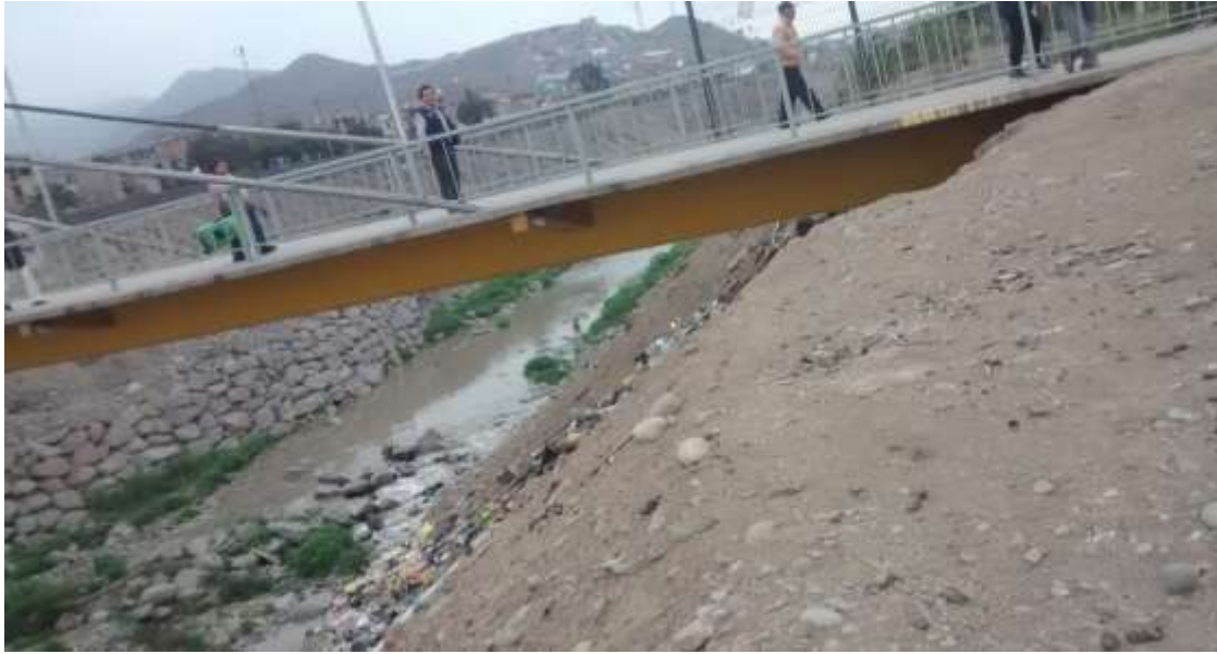
Se observa la falta de control del río Rímac en el sector del puente talavera – Fuente propia.
