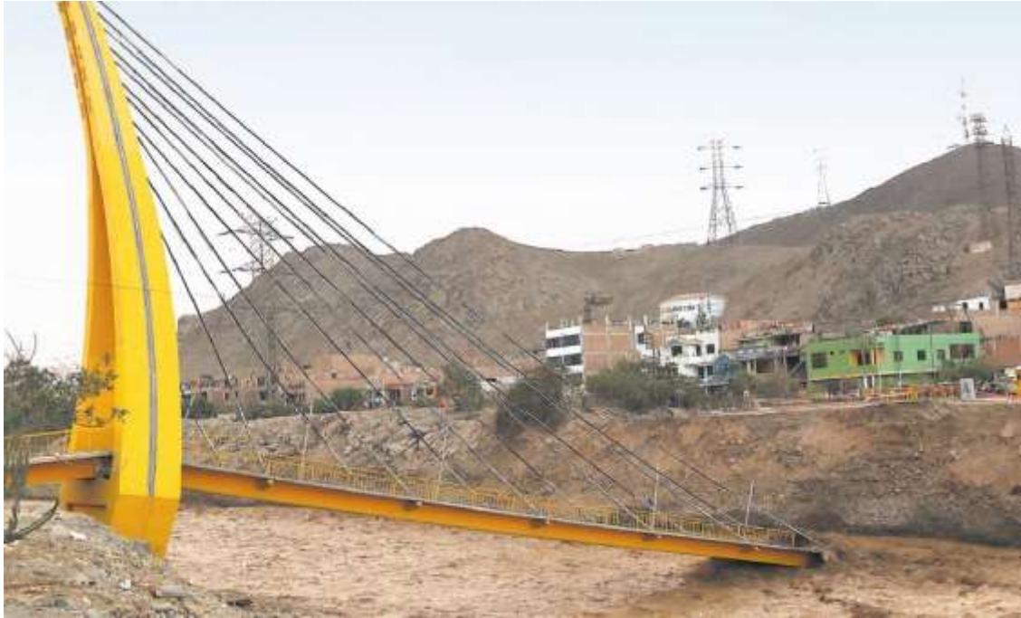
Vista de socavamiento del puente Talavera – Fuente propia.
