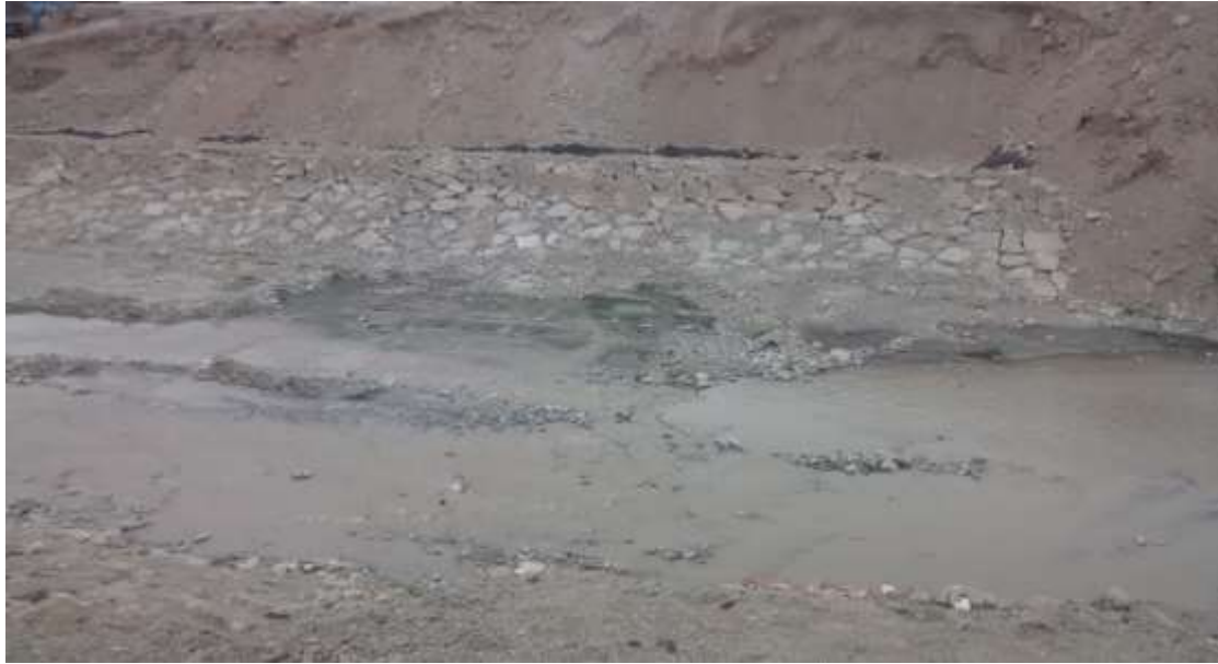
Se muestra la mala planificación en obras – Fuente propia.
