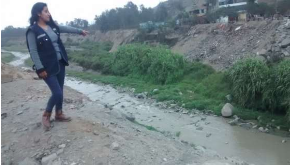
Vista del rio Rímac relleno con desechos y esto ocasionara posteriormente un socavamiento en los costados – Fuente propia.
