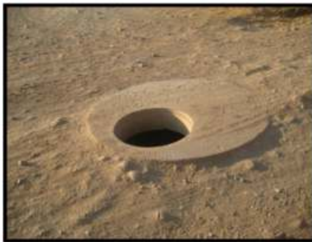
Figura N° 1 – Buzones Instalados sin Funcionamiento
