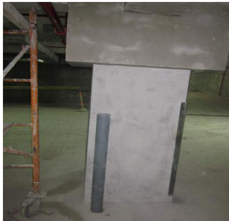
Figura 24: Caso de interferencia entre una tubería y la estructura (Fuente: Elaboración propia Edificio Duplo)
