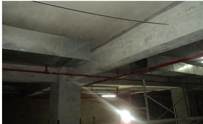
Figura 23: Interferencia entre tuberías de agua contra incendio con ductos de extracción de monóxido (Fuente: Elaboración propia edificio Duplo)
