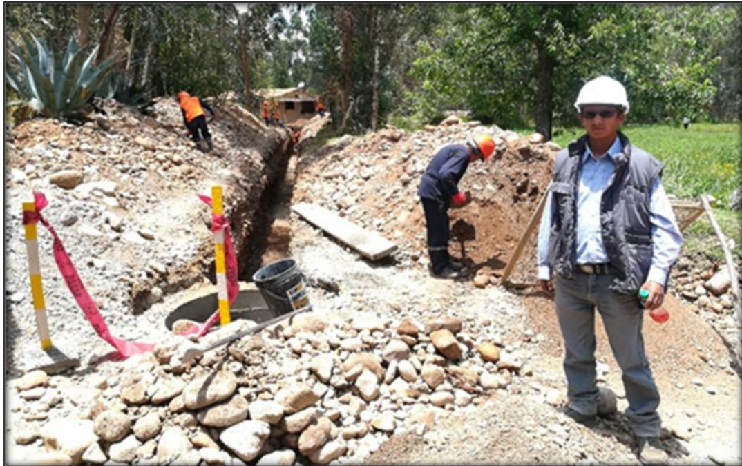
FOTO N° 17: Se observa el trabajo de llenado de zanja con material seleccionado y arena gruesa, se observa el compactado por capas de 0.15 m.
