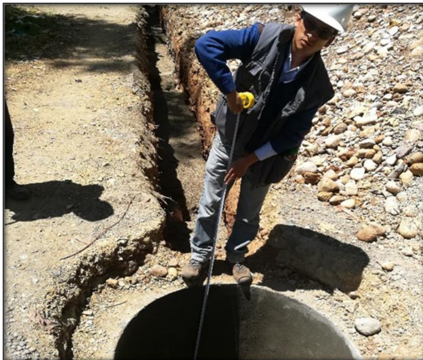
FOTO N° 14: Se realizó la prueba hidráulica donde se verificó una pérdida de 3cm representado el 2% permitido por la norma.
