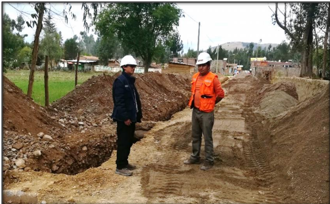
FOTO N° 20: Se observa al asistente de obra, en la excavación de zanja con equipo, en el proceso se rompieron tuberías de la red agua existente.
