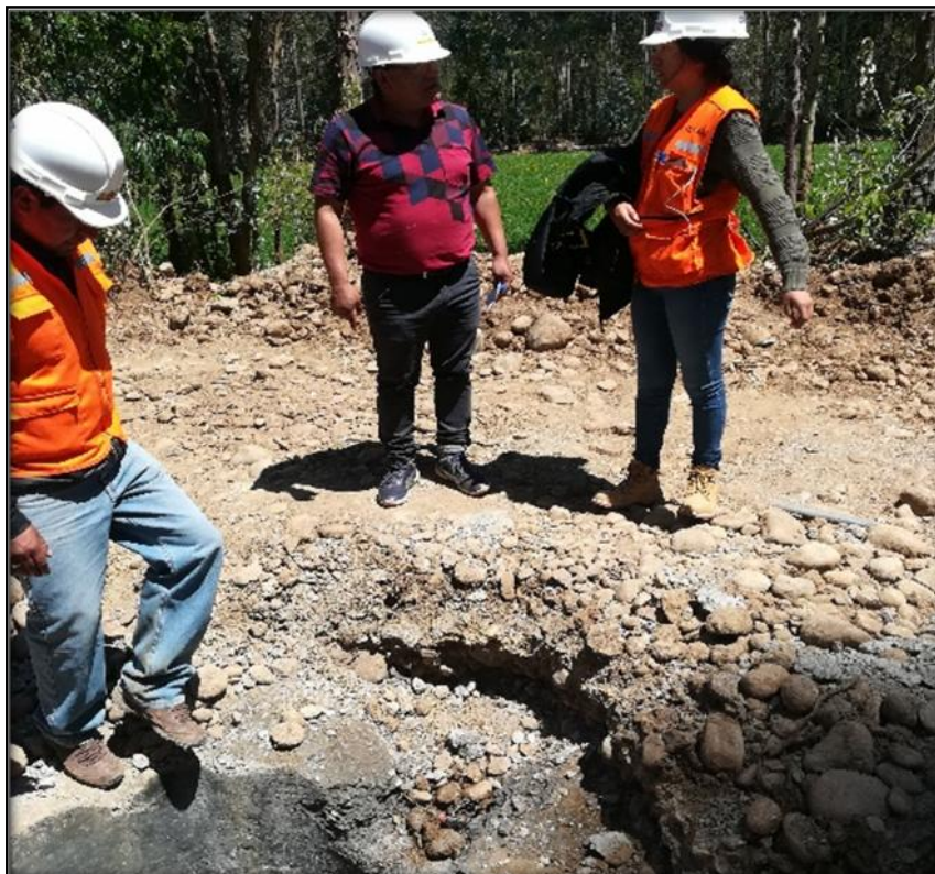
FOTO N° 12: Se observa al feje de supervisión y residente de obra, cuando ordena la democión de un buzón por no cumplir con la verticalidad y espesor de paredes
