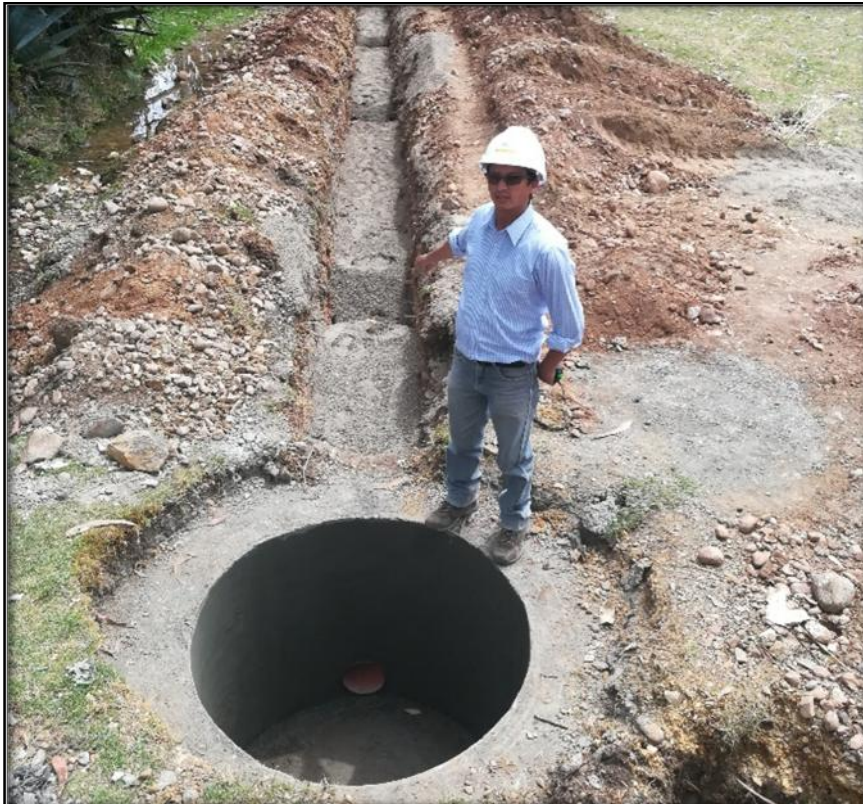
Foto N° 16: Ejecución de recubrimiento de tubería H=0.30 con material seleccionado, para su posterior liberación y tapado de zanja.
