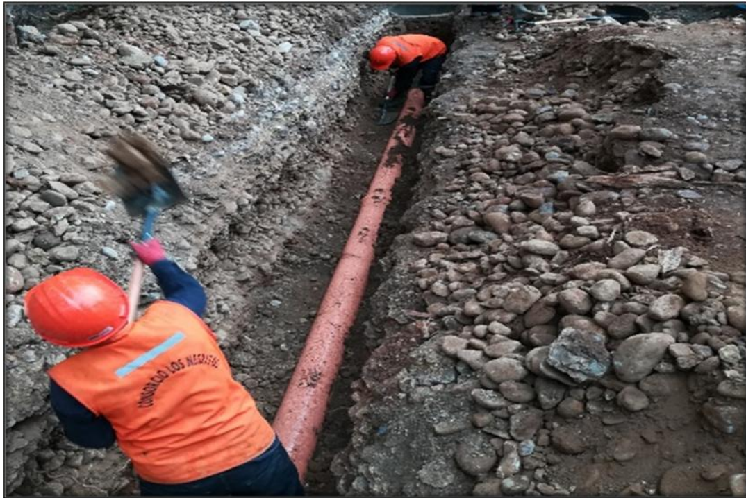
FOTO N° 05: Se observa la corrección del alineamiento de tubería, y corrección del tapado de tubería.
