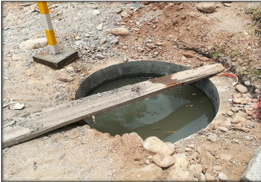
FOTO N° 13: Se observa el buzón llenado con agua, para comprobar la pérdida de carga y posibles fugas en la tubería, esta prueba se realiza por un periodo de 24 horas, con una pendiente permisible del 3%.
