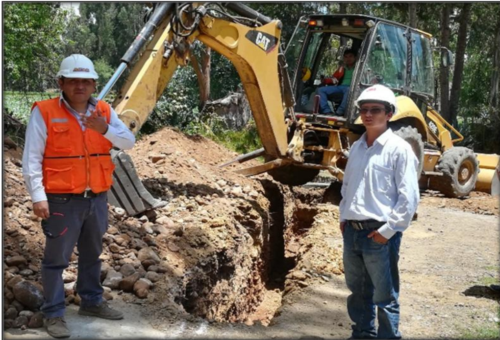
FOTO N° 11: Se observa al Ing. Residente de obra dirigiendo la excavación de zanja para tubería con equipo.
