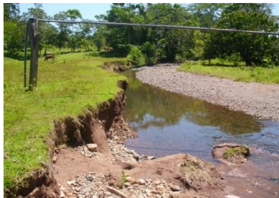
Figura 4.8 cruce aéreo Fuente: propia "saneamiento básico" curso virtual (2015) [digital]. Recuperado de http://eduvirtual/RHidricos/pág./185
