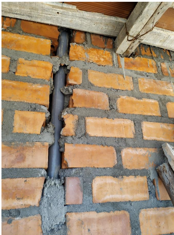
Fotografía N°33: Muro picado para poder alojar la tubería y se está relleno con concreto de una mala manera.
