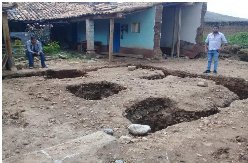
Fotografía N°05: Excavación de zanjas de forma irregular
