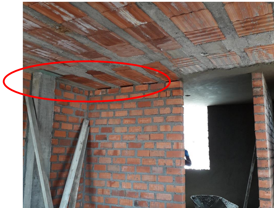
Fotografía N°20: Junta entre la losa y el muro escaso
