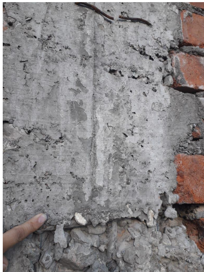
Fotografía N°14: Cangrejas en las columnas y pared
