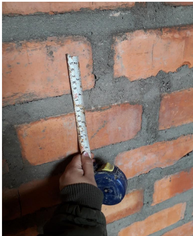
Fotografía N°18: Junta horizontal con espesor de 3 cm.
