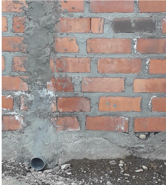
Fotografía N°36: Se colocó la tubería picando el sobrecimiento y luego se hizo un mal vaceado de concreto.
