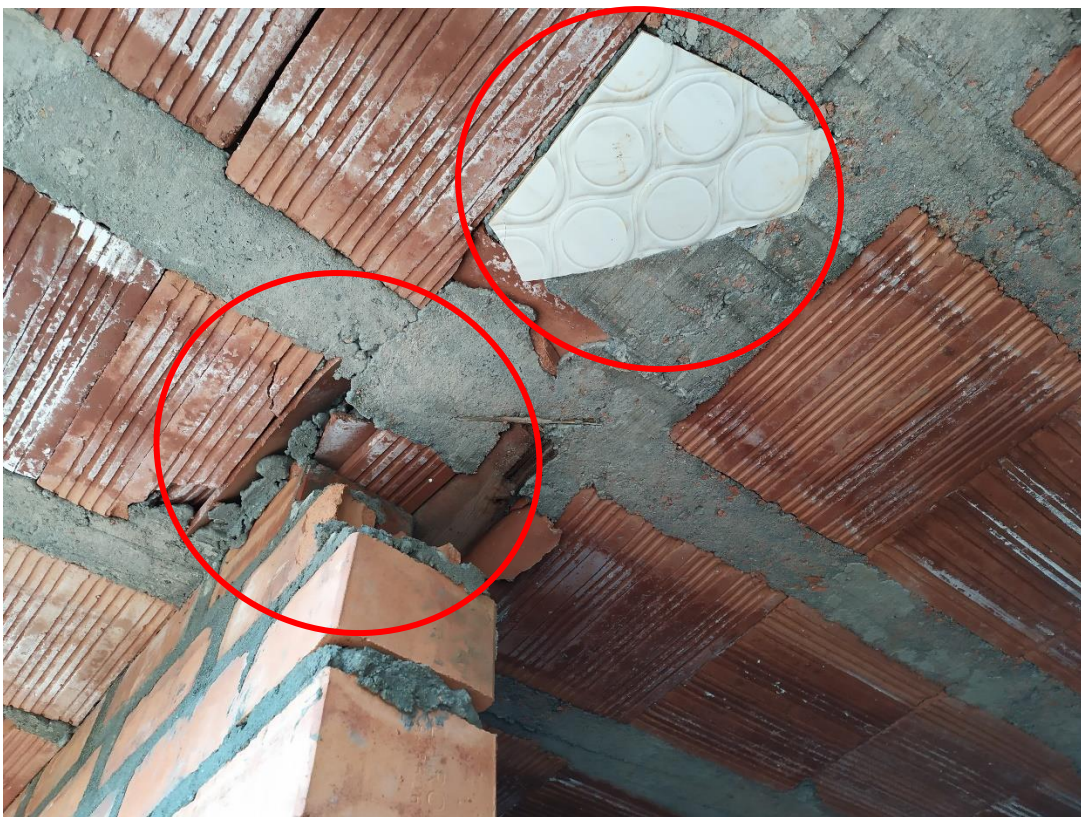
Fotografía N°28: Ladrillos de techo mal estado e incluso están rotos además de estar una cerámica adherida al techo
