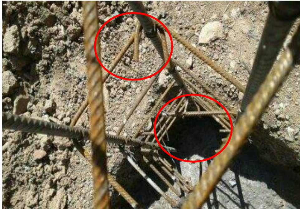
Fotografía N°16: Largos mínimos incorrectos y diferentes en los estribos a lo largo de la columna.
