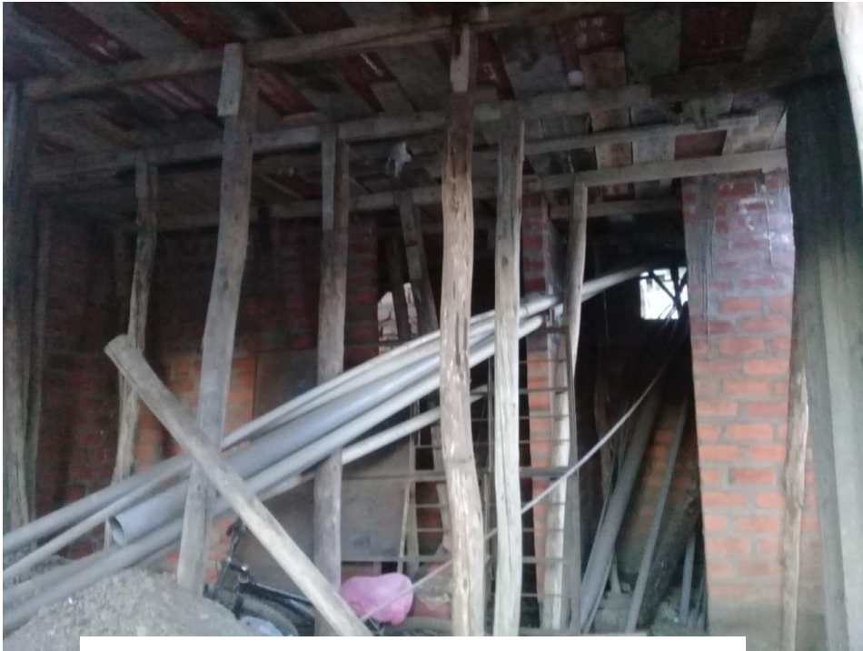
Fotografía N°46: Tuberías mal almacenadas, expuestas a flexionarse
