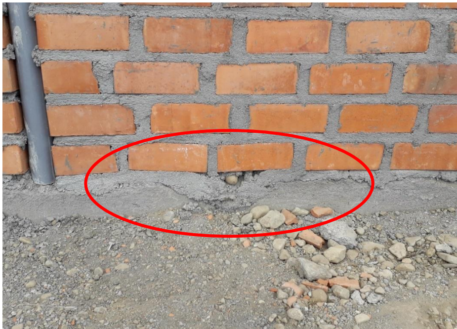
Fotografía N°10: Sobrecimiento mal vaceado, y exceso de agregado.
