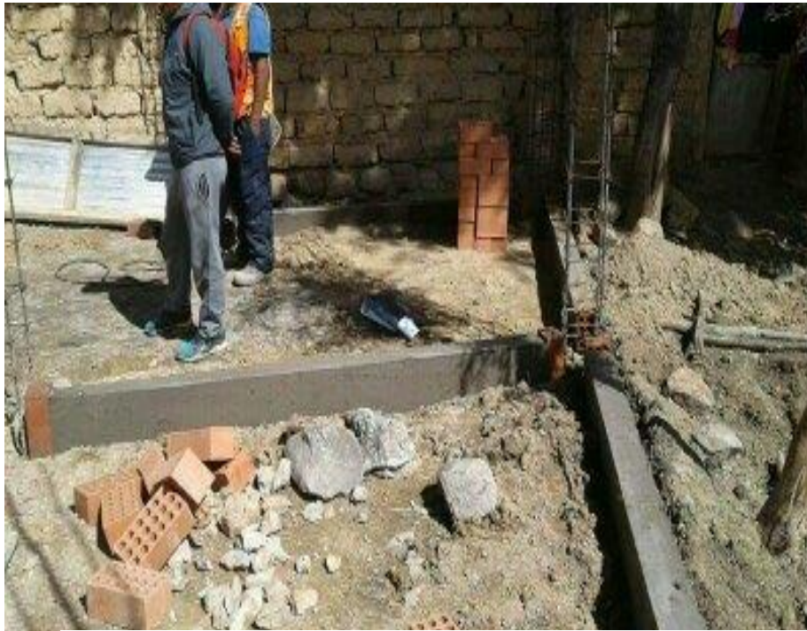
Fotografía N°44: Ladrillos de muro colocados en cualquier parte y expuesto a cualquier daño
