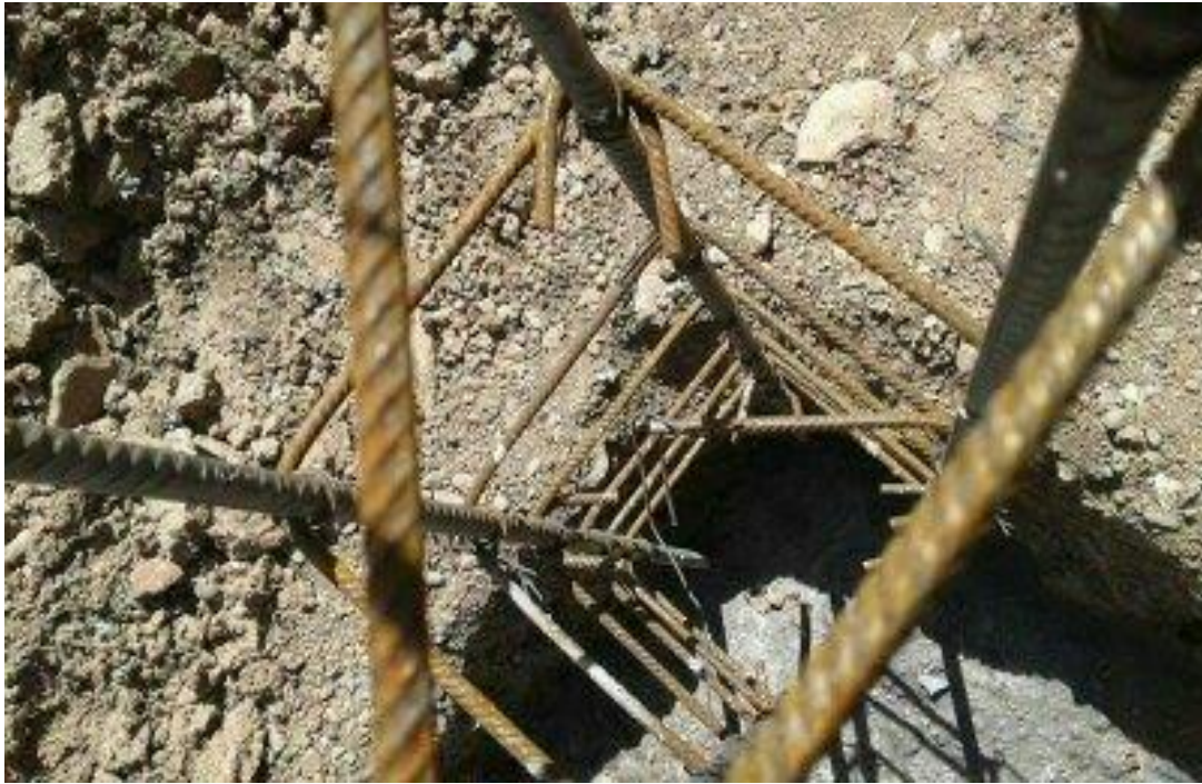
Fotografía N°49: Acero oxidado en las columnas
