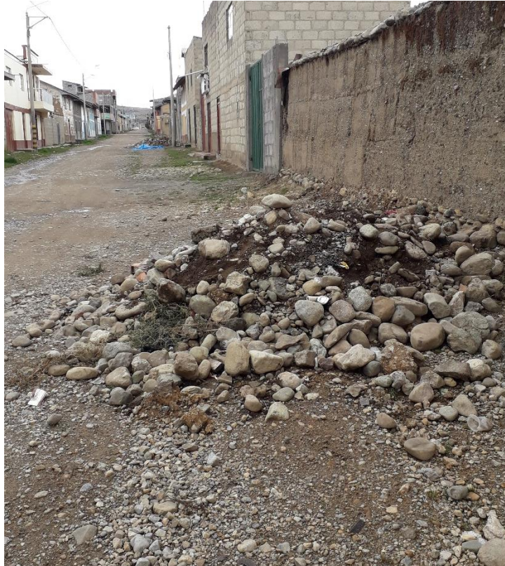
Fotografía N°09: Piedras para las zapatas inadecuadas
