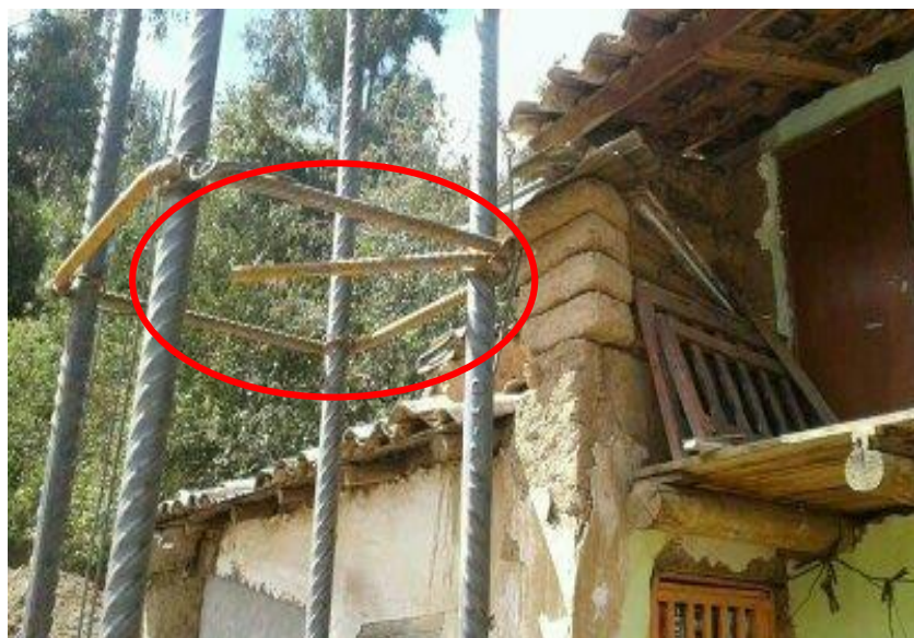
Fotografía N°15: Ganchos del acero incorrecto
