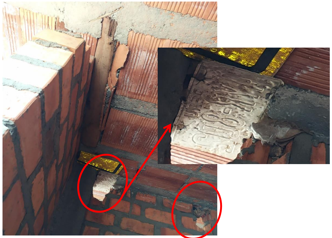
Fotografía N°30: Se utilizó cualquier material para las zonas donde no llegó concreto en el vaciado de techo hasta colocaron una placa de vehículo y el ladrillo de muro está roto.
