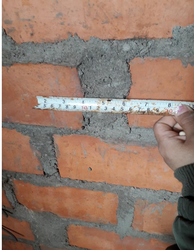
Fotografía N°17: Juntas verticales con espesor de 5 cm.
