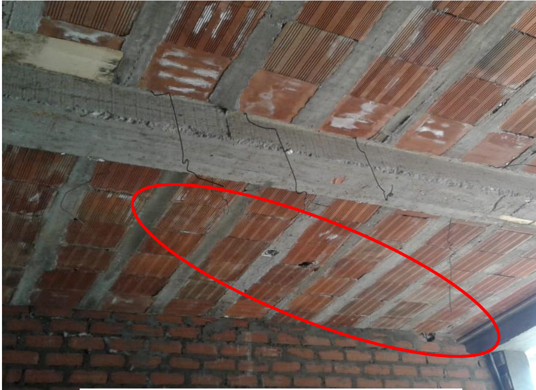
Fotografía N°27: Ladrillos de techo mal estado
