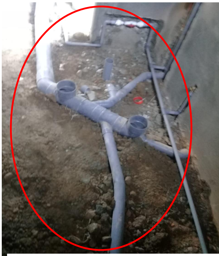
Fotografía N°31: Suelo no compactado e irregular para las instalaciones, por la mano de obra no calificada encargada de realizarlo.
