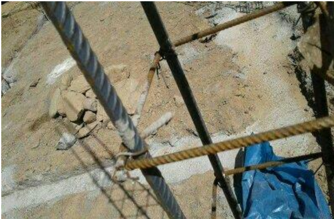
Fotografía N°48: Acero de los estribos oxidados
