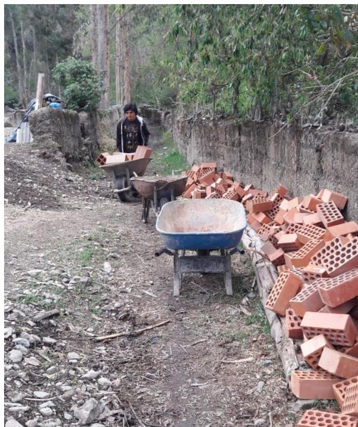
Fotografía N°45: Ladrillos de muro mal almacenado y no apliados.
