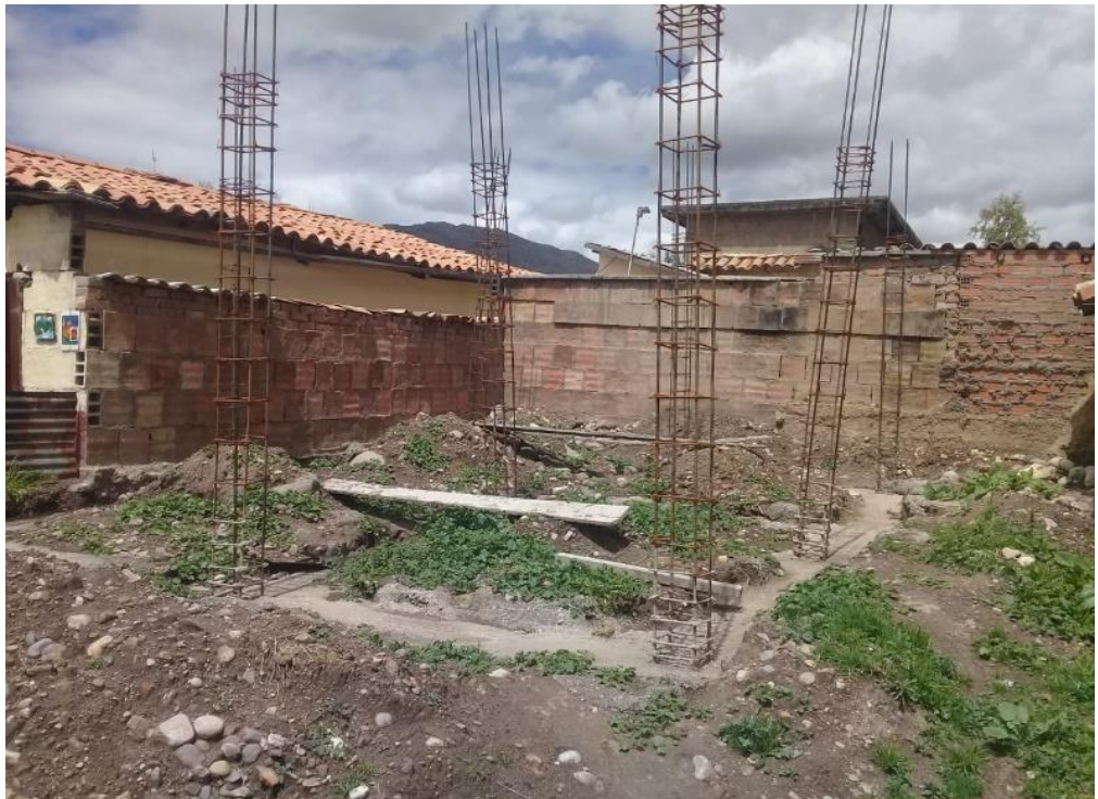
Fotografía N°11: Las columnas fueron armadas con acero en mal estado(oxidados)
