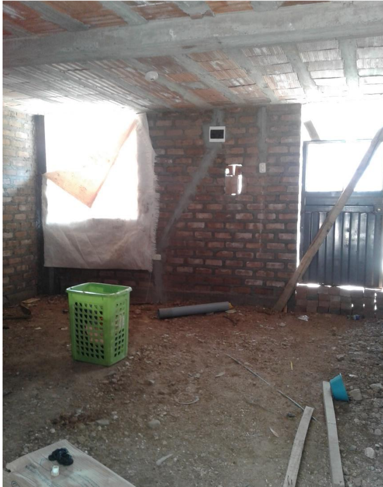
Fotografía N°38: Evidentemente se picó el muro para colocar tuberías para instalaciones secas
