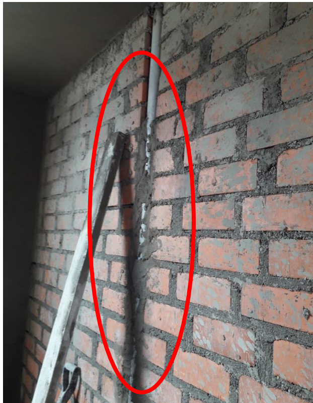
Fotografía N°35: No se realizó una falsa columna para alojar las tuberías.
