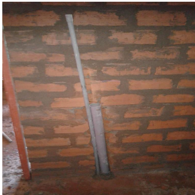
Fotografía N°37: Se picó el muro, se colocó las tuberías, y el muro no tiene sobrecimiento
