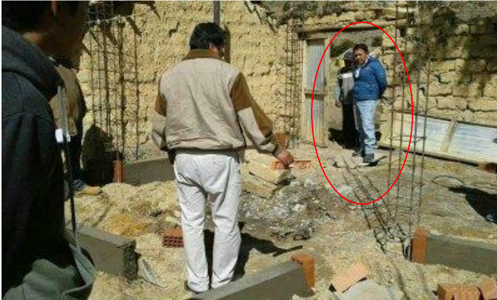
ING. JAVIER MONTERO SAKODA (SUPERVISA LAS OBRAS) MAS NO EL QUE ESTA EN LA DECLARACION
