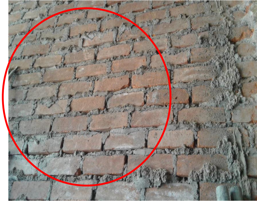
Fotografía N°19: Exceso de mortero en todo el muro.
