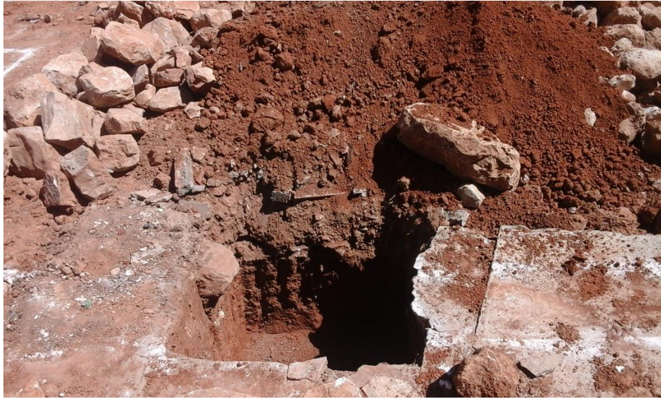
Fotografía N°06: Excavación de zapatas, altura menor a la dispuesta en el plano de cimentaciones
