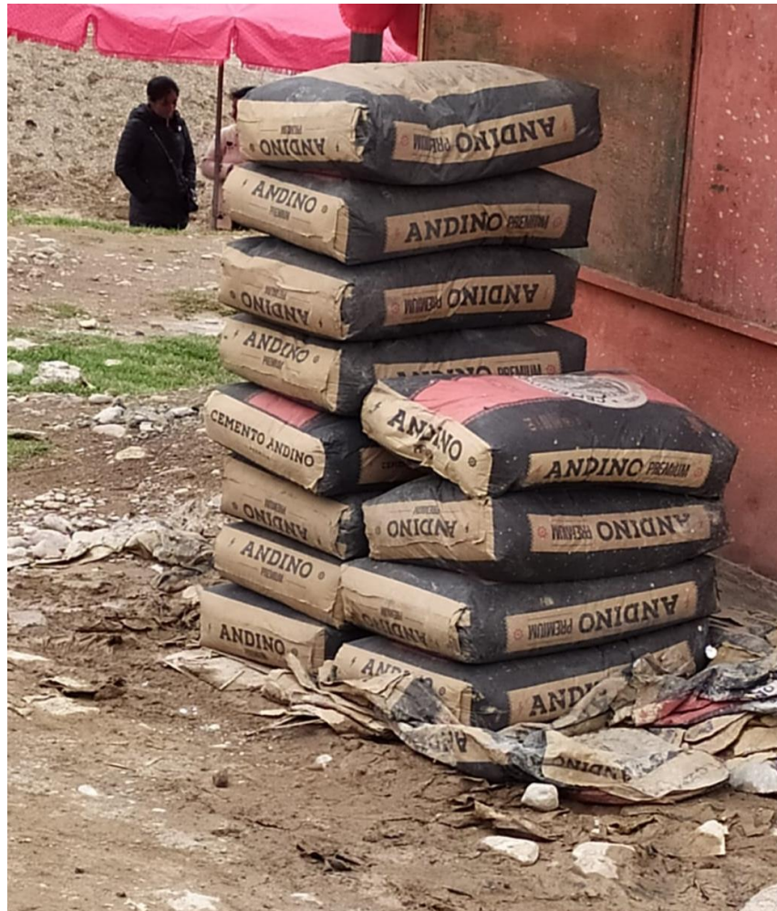
Fotografía N°40: Almacenamiento de cemento inadecuado a pesar de que están apilados está en contacto con el suelo.
