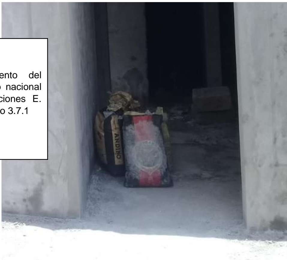
Fotografía N°39: Almacenamiento de cemento inadecuado además de no estar apilados y está en contacto con el suelo
