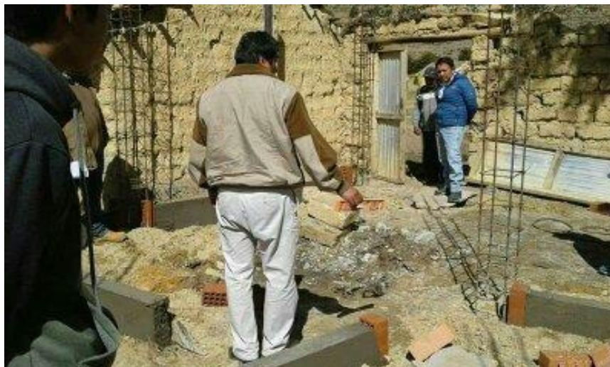
Fotografía N°01: Ausencia de la supervisión profesional en la ejecución de las viviendas
