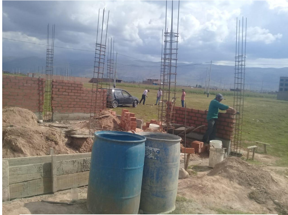
Fotografía N°24: Asentado de ladrillos de muro con exceso de mortero.
