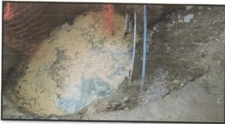
FOTOGRAFIA N°6.- EXCAVACIONES PRESENCIA DE AGUA SUBTERRANEA EN LA OBRA DEL PROYECTO "AMPLIACIÓN DE LA RED DE AGUA POTABLE Y ALCANTARILLADO DEL ASENTAMIENTO HUMANO JULIO LA ROSA – LA MERCED – CHANCHAMAYO – JUNÍN"
