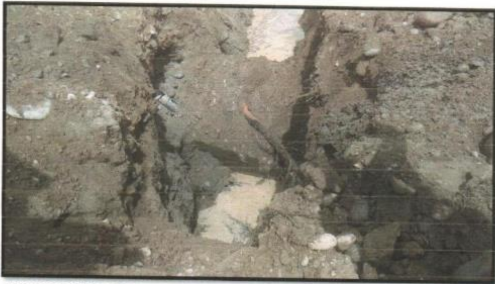
FOTOGRAFIA N°1.-VICIO OCULTO ESTRUCTURA DE CONCRETO ARMADO EN EL TRAMO BP3 -BP10 EN LA OBRA DEL PROYECTO "AMPLIACIÓN DE LA RED DE AGUA POTABLE Y ALCANTARILLADO DEL ASENTAMIENTO HUMANO JULIO LA ROSA - LA MERCED - CHANCHAMAYO - JUNÍN"
