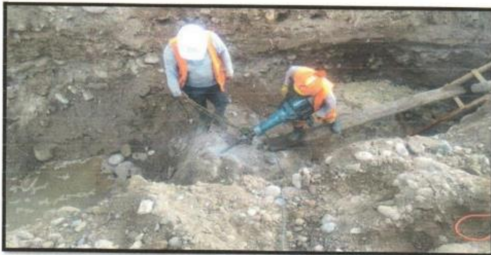
FOTOGRAFIA N°4.- -DEMOLICION VICIO OCULTO ESTRUCTURA DE CONCRETO ARMADO EN EL TRAMO BP12 –BP15 CON ROTOMARTILLO EN LA OBRA DEL PROYECTO "AMPLIACIÓN DE LA RED DE AGUA POTABLE Y ALCANTARILLADO DEL ASENTAMIENTO HUMANO JULIO LA ROSA – LA MERCED – CHANCHAMAYO – JUNÍN"
