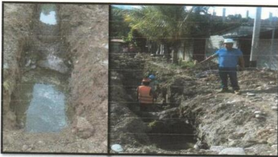
FOTOGRAFIA N°2.-VICIO OCULTO ESTRUCTURA DE CONCRETO ARMADO EN EL TRAMO BP12 -BP15 EN LA OBRA DEL PROYECTO "AMPLIACIÓN DE LA RED DE AGUA POTABLE Y ALCANTARILLADO DEL ASENTAMIENTO HUMANO JULIO LA ROSA - LA MERCED - CHANCHAMAYO - JUNÍN"
