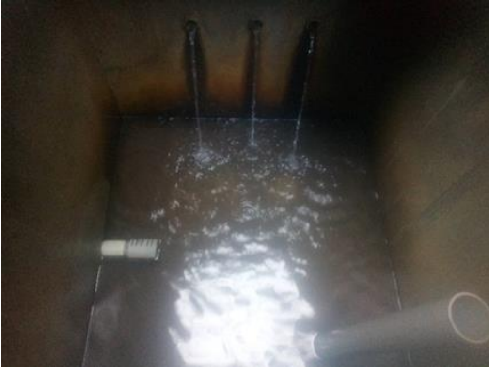
Fotografía 1. Vista de la captación del sistema, sin adecuado mantenimiento.
