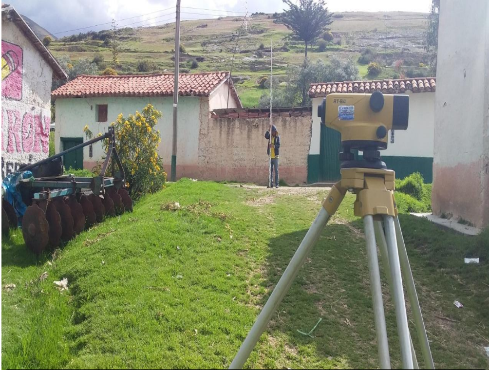
FOTO N° 05: En la fotografía se puede observar realizando la topografía del terreno por donde pasara las tuberías de la red de distribución en el Gr. Bolívar.
