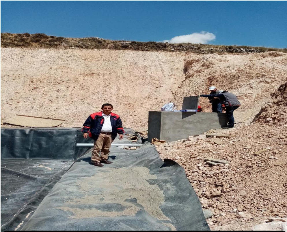
FOTO N° 12: En la imagen se puede apreciar el reservorio, el cual almacenara el caudal para abastecer el riego tecnificado de las parcelas en un área de 65 has urbanas anuales en el distrito de Chambara para la producción agrícola.
