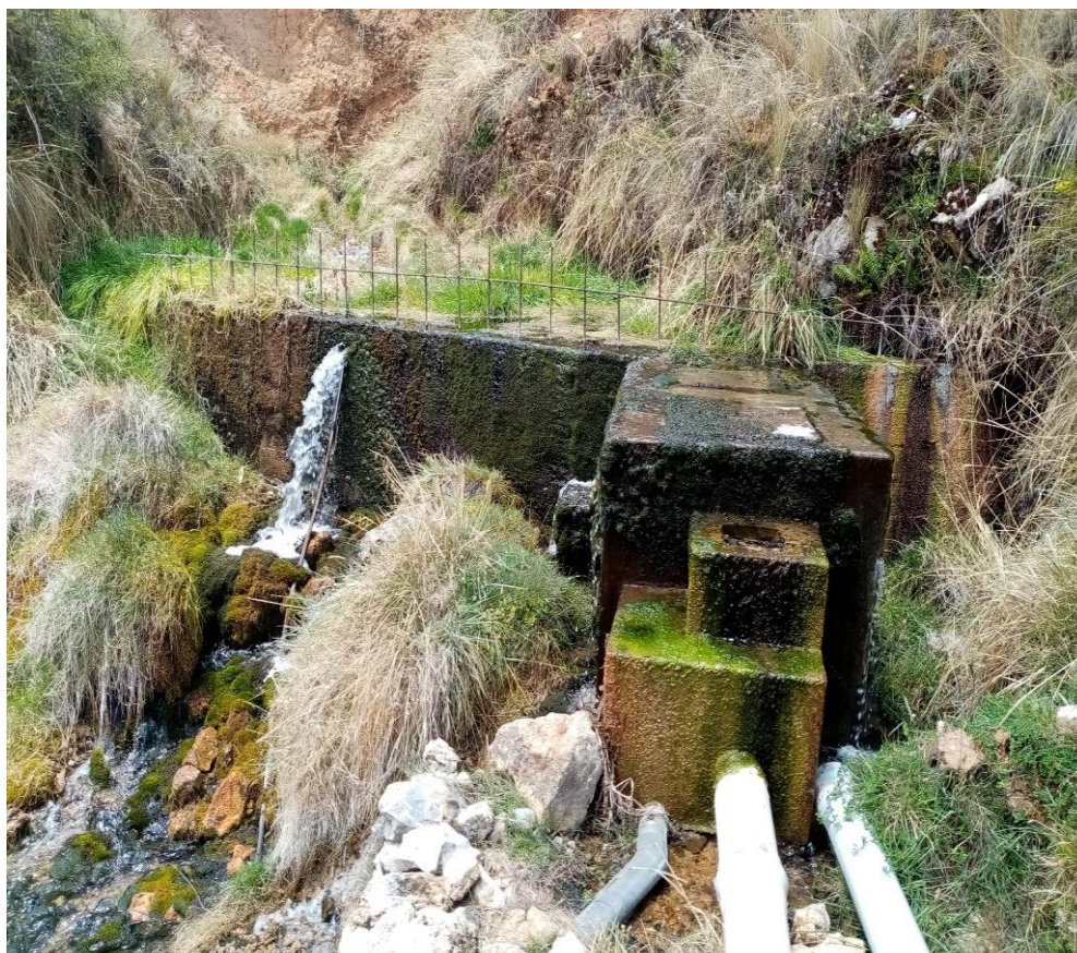
FOTO N° 10: En la imagen se puede observar la toma de captación, que el aforo en el mes de mayo tiene un caudal de 16 lt/seg y en el mes de septiembre 12 lt/seg., caudal obtenido de un manantial denominado Mitu Uclo.
