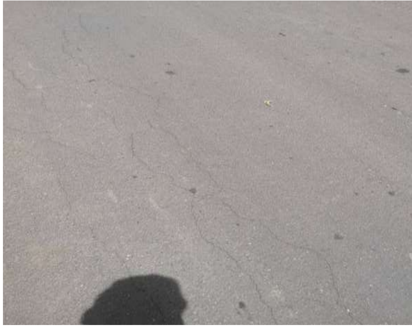
FOTOGRAFIA N° 24: Piel de cocodrilo de severidad bajo KM 15+771
