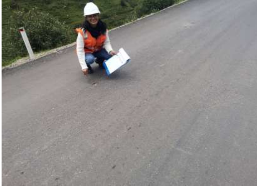
FOTOGRAFIA N° 16: Huecos de severidad medio KM 13+104
