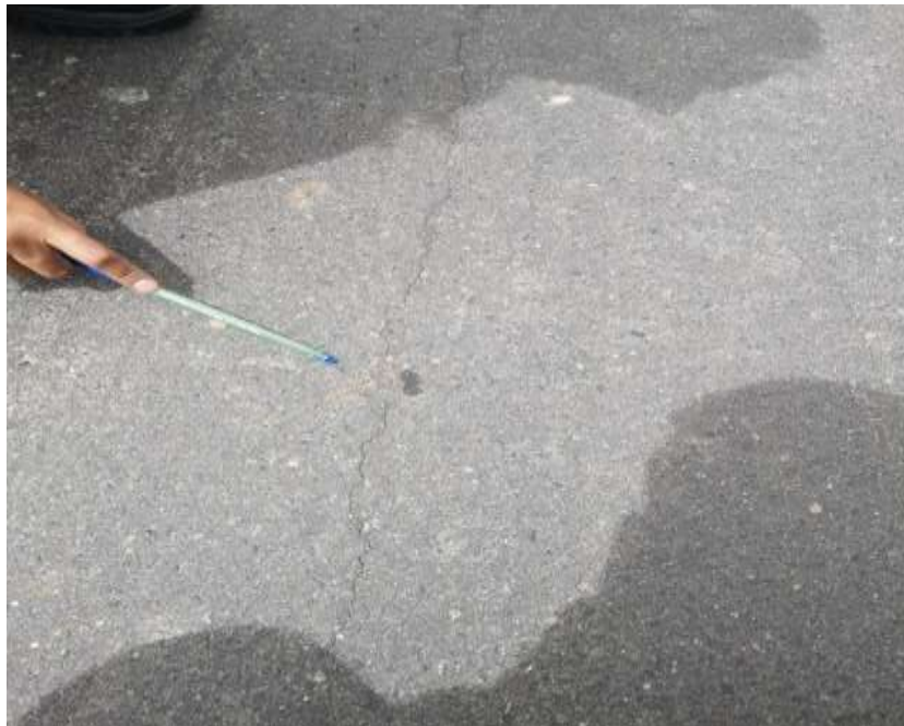
FOTOGRAFIA N° 29: Grietas longitudinales de severidad bajo KM 19+318
