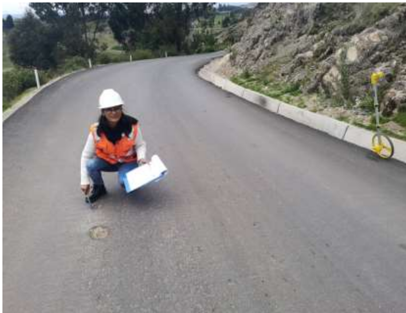
FOTOGRAFIA N° 17: Huecos de severidad medio KM 14+016
