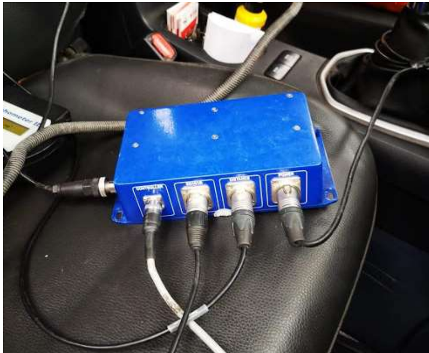
FOTOGRAFIA N° 06: COMPONENTES INSTALADOS A LA FUENTE DE PODER
