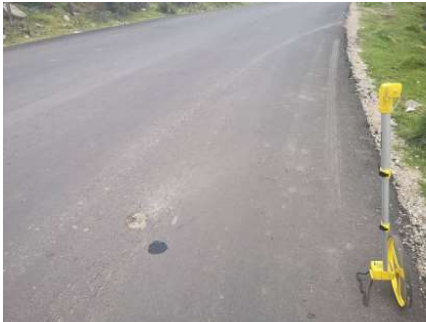
FOTOGRAFIA N° 018: Huecos de severidad medio KM 14+253
