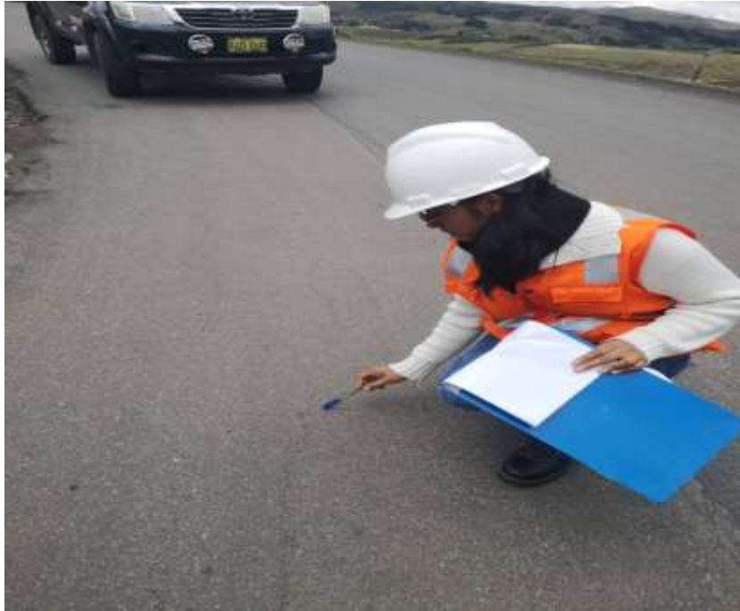
FOTOGRAFIA N° 22: Grietas longitudinales de severidad bajo KM 15+600
