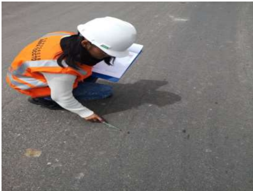
FOTOGRAFIA N° 27: Grietas longitudinales de severidad bajo KM 19+072
