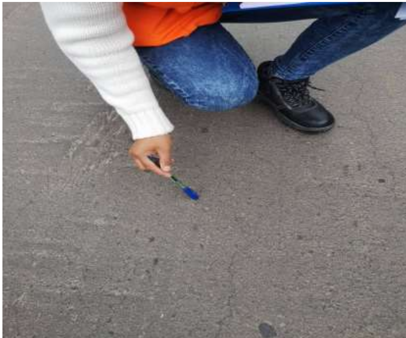
FOTOGRAFIA N° 21: Grietas longitudinales de severidad bajo KM 15+301
