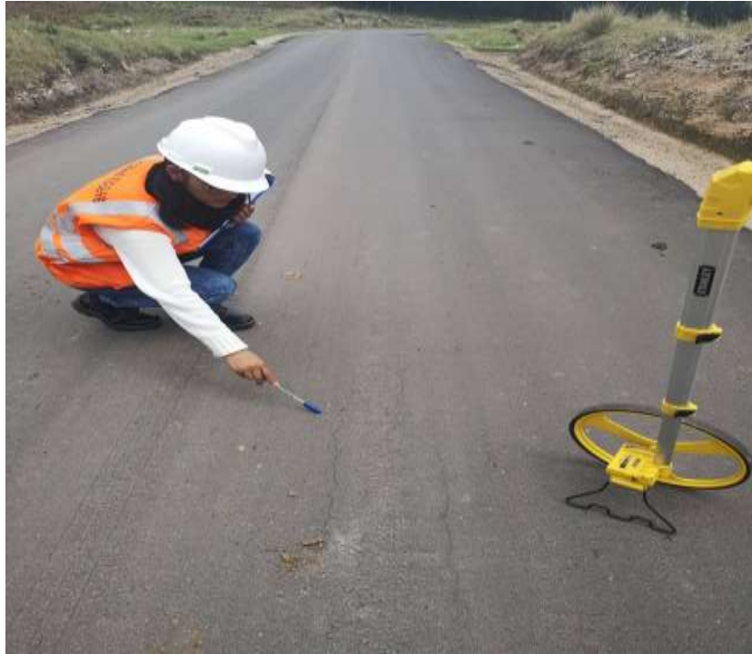
FOTOGRAFIA N° 28: Grietas longitudinales de severidad bajo KM 19+242
