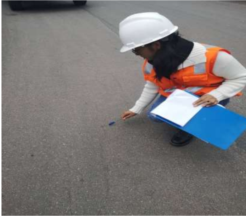
FOTOGRAFIA N° 30: Grietas longitudinales de severidad bajo KM19+718
