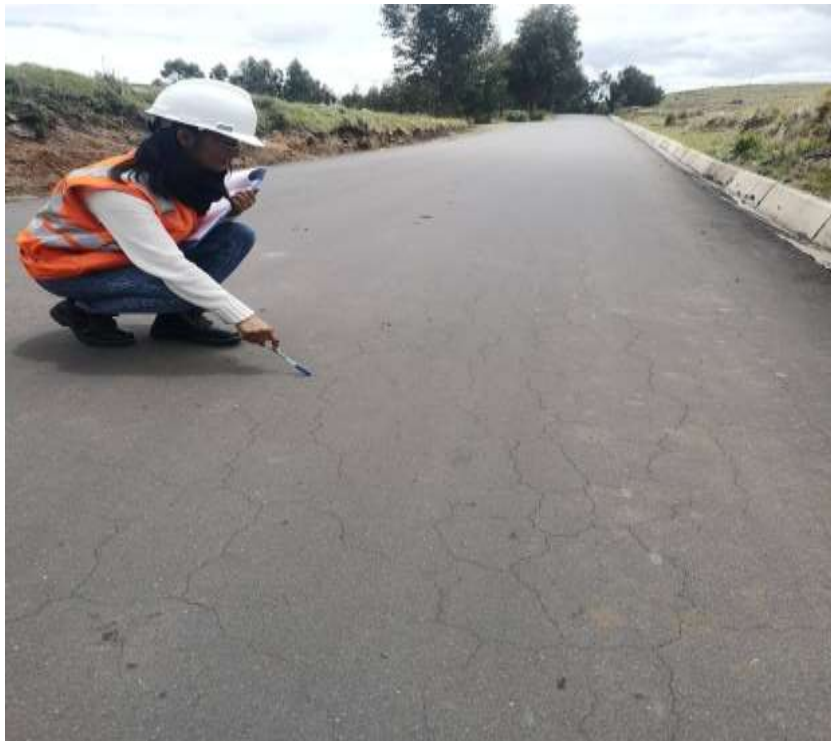
FOTOGRAFIA N° 23: Piel de cocodrilo de severidad bajo KM 15+686
