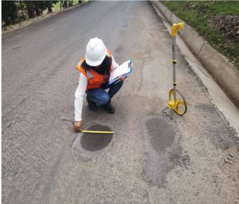
FOTOGRAFIA N° 020: Parcheo de severidad bajo KM 15+237
