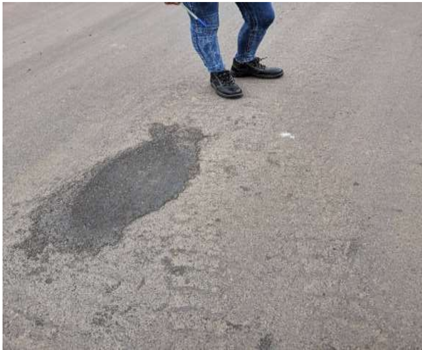
FOTOGRAFIA N° 026: Parcheo de severidad bajo KM 19+025
