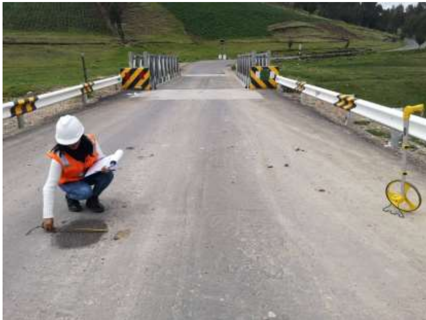
FOTOGRAFIA N° 19: Parcheo de severidad bajo KM 14+470
