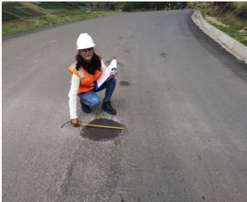
FOTOGRAFIA N° 25: Parcheo de severidad bajo KM 17+552
