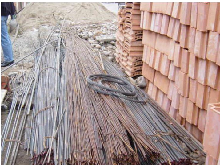
FIGURA N° 08: DESORDEN EN EL ALMACENAMIENTO DE MATERIAL.
