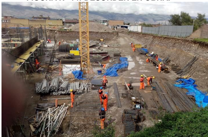
FIGURA N° 14: DESORDEN EN OBRA.
