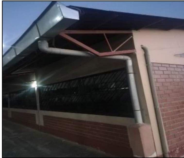
Fotografía N.º 21: Sistema de bajantes de agua pluvial hacia el canal recolector de la Facultad Ingeniería de la Universidad Peruana Los Andes, 2019.
