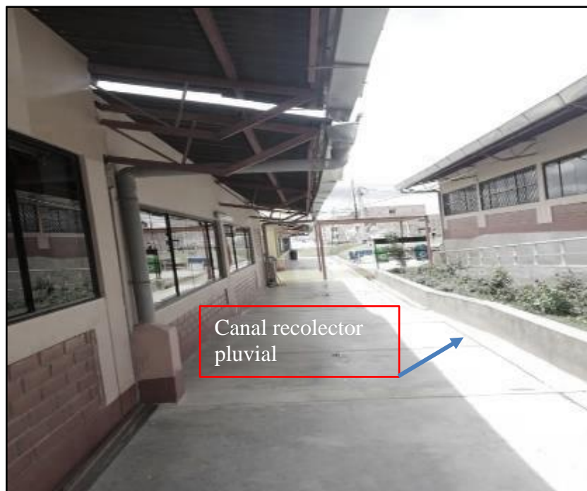
Fotografía N.º 20: Sistema de Canaletas de los techos con cubiertas de la Facultad Ingeniería de la Universidad Peruana Los Andes, 2019.
