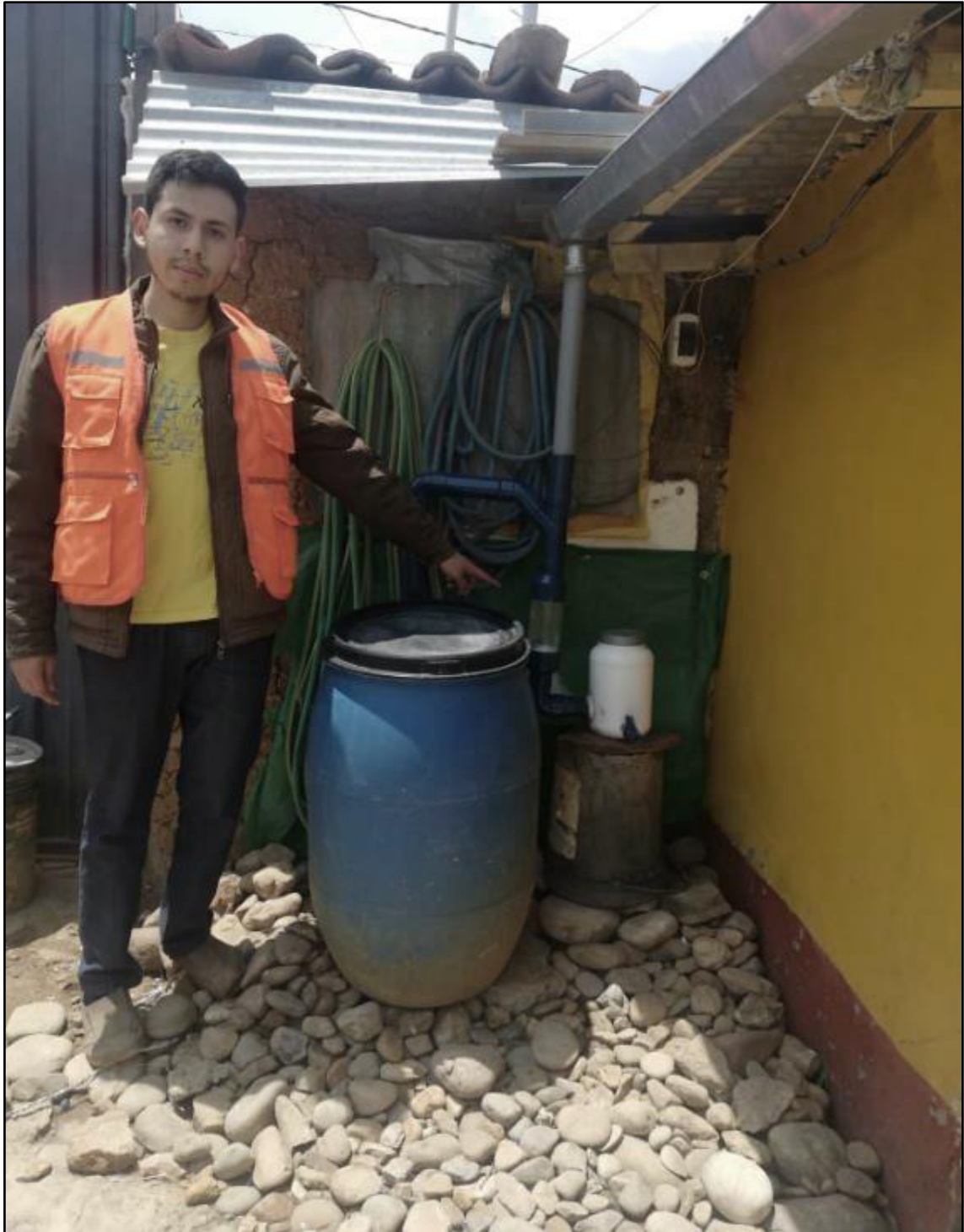
Fotografía N.º 14: Instalación del Sistema Interceptor de Primeras Aguas con capacidad de 3.6 litros en edificación rustica en el distrito de El Tambo - Huancayo 2018.
