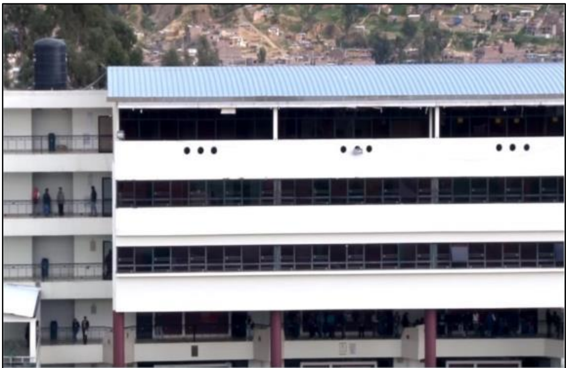
Fotografía N.º 16: Techo del Pabellón “I” de la Facultad de Ingeniería de la Universidad Peruana Los Andes, 2019.
