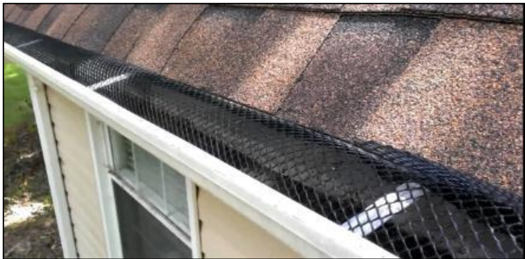
Figura 45. Canaletas provistas de mallas
