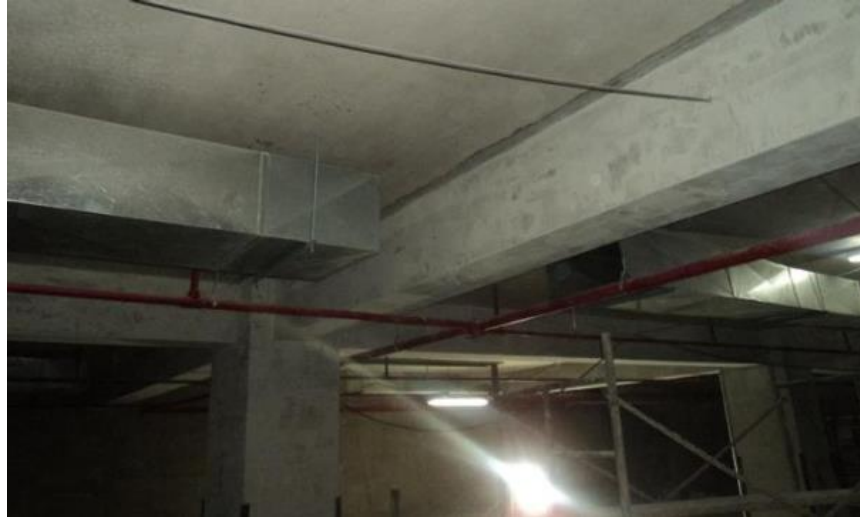
Figura 31 : Interferencia entre tuberías de agua contra incendio con ductos de extracción de monóxido.
