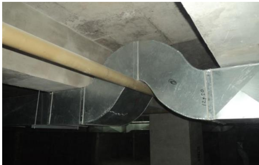
Figura 33 : Interferencia entre un ducto y una tubería
