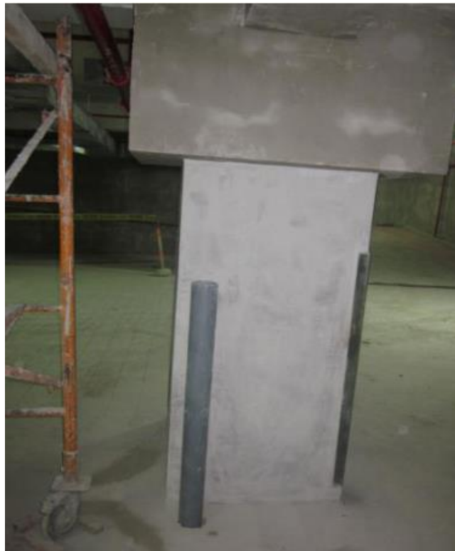
Figura 32 : Caso de interferencia entre una tubería y la estructura
