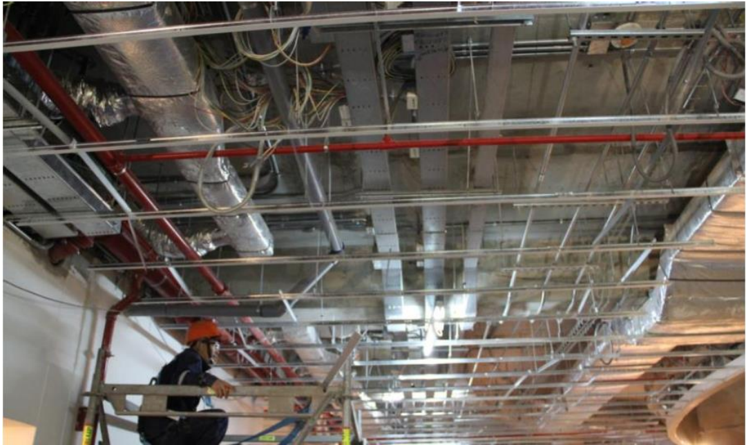
Figura 37 : Complejos recorridos de las instalaciones ubicadas encima del FCR
