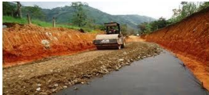
Figura 10. Imagen del afirmado de una sub base Tomada de (Cardenas, Fundamentos de vias de comunicacion y Carreteras, 2014)
