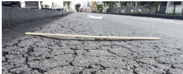
Figura 8. Imagen de desniveles en pavimentos Tomada de (Cardenas, Fundamentos de vias de comunicacion y Carreteras, 2014)
