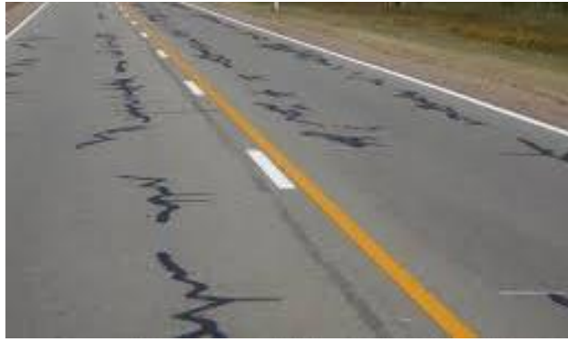
Figura 15. Imagen de Fisuramiento Longitudinal Tomado de "diseño de carreteras" curso virtual (2015) [digital]. Recuperado de http://eduvirtual/gnss/.org/?/pág./85
