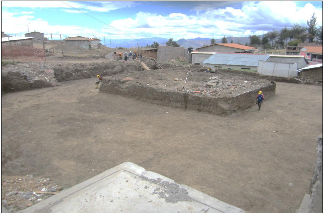
Fotografía A2-1. Se muestra el trabajo realizado de nivelación en el terreno de los bloques – I, II y III al 100%.
