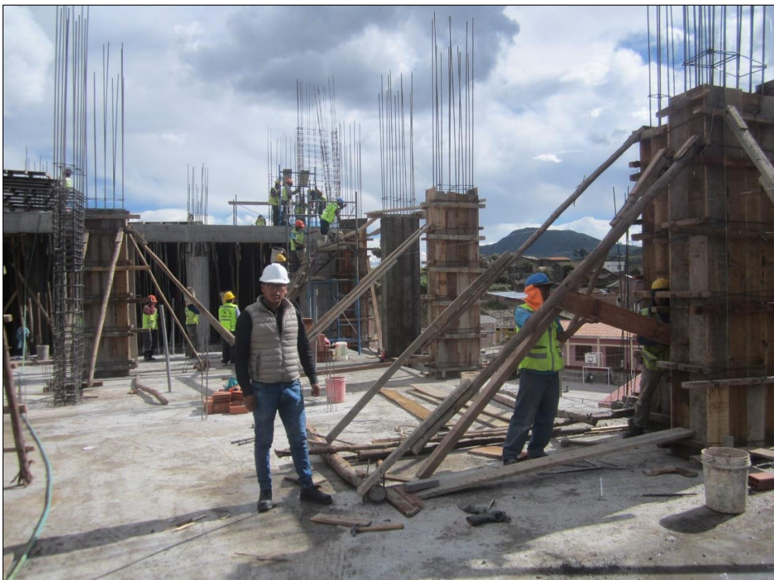
Fotografía A2-10. Verificación de los trabajos de encofrado para columnas tipo C-1, y Placas PL-5, 6, 7, 8, 9, 10 y 11. Bloque – III.
