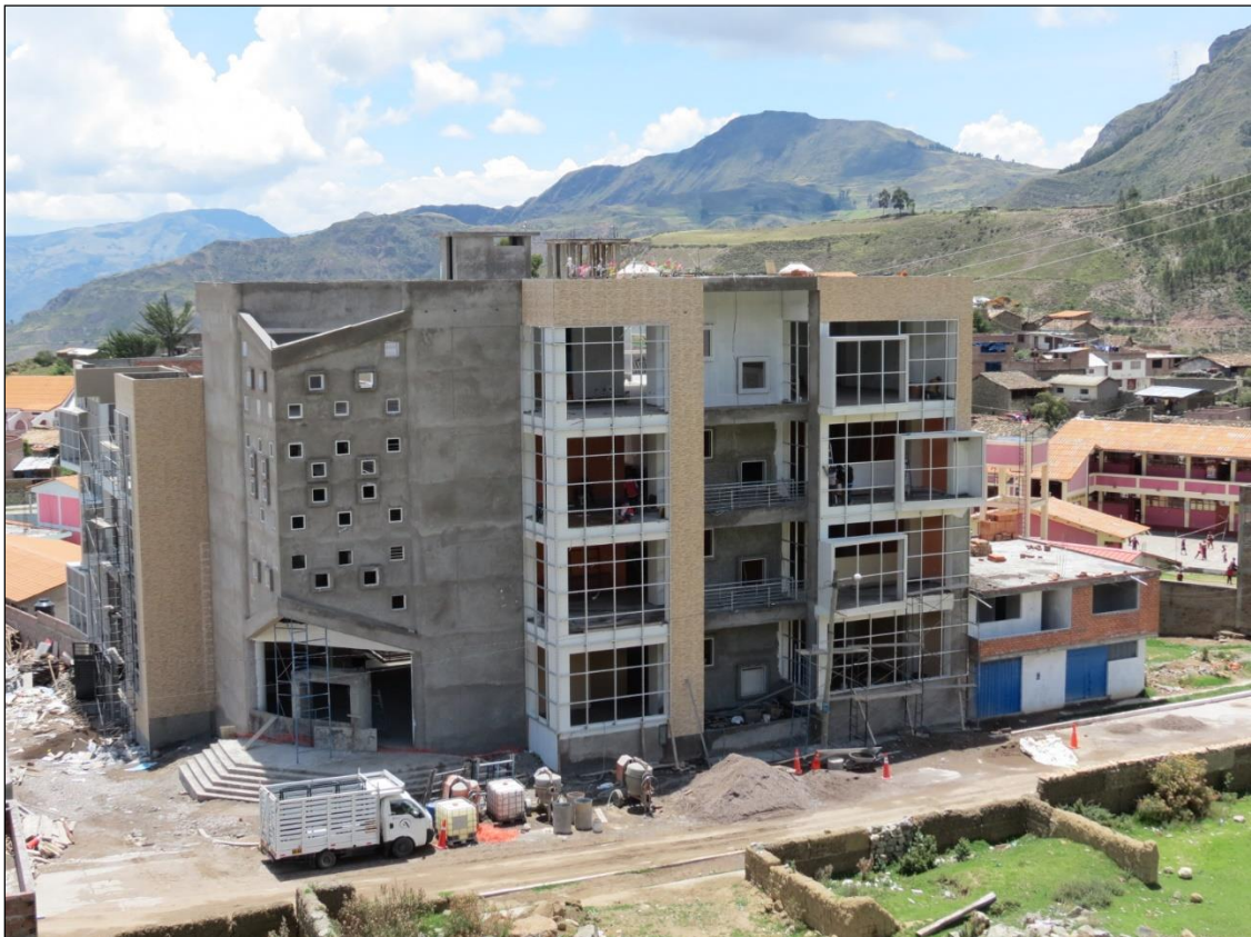
Fotografía A2-12. Se muestra la ejecución de la especialidad de estructuras al 100%, de los bloques I, II y III.
