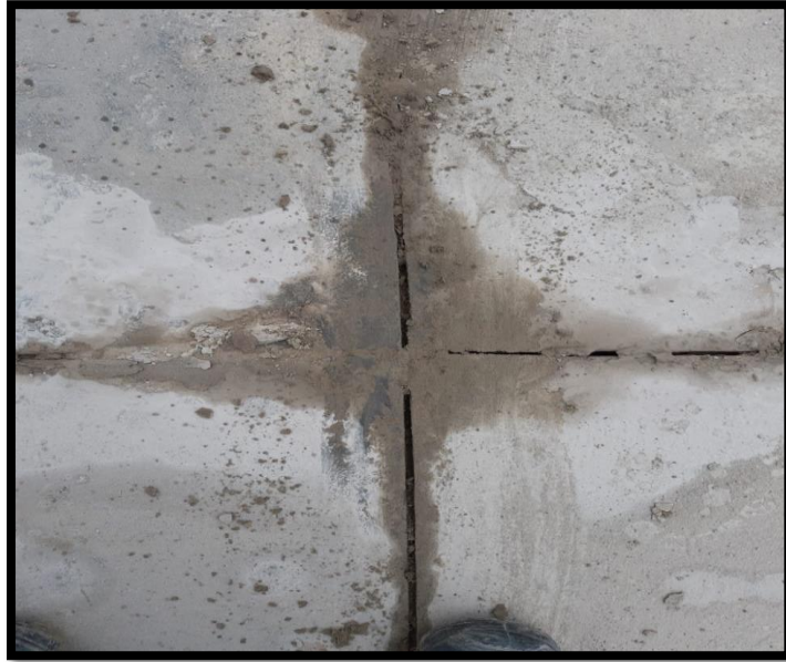
Foto 27: Juntas transversales y longitudinales.
