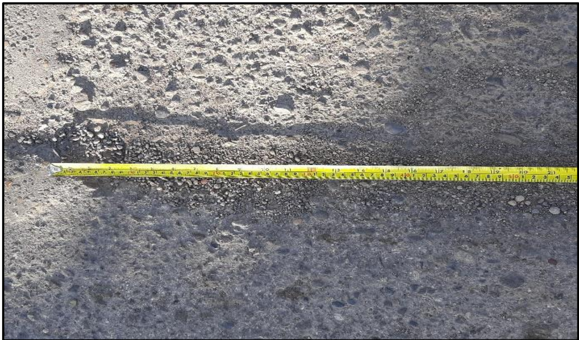
Fotografía 5. Vista de peladura y desprendimientos de gravedad 2, evidenciándose pérdida de ligante bituminoso o del agregado.
