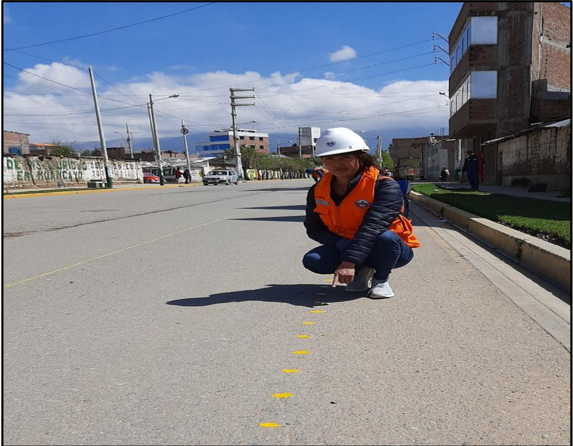
Fotografía 2. Identificación de los deterioros del pavimento de la Av. José Olaya, progresiva 0+520.
