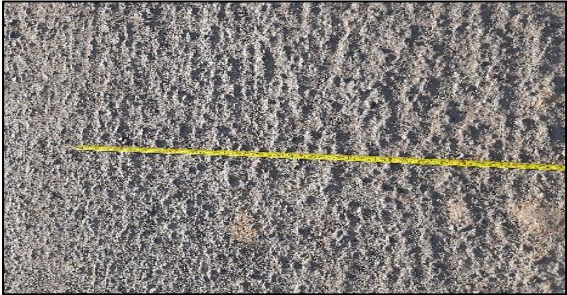
Fotografía 6. Vista de peladura y desprendimientos de gravedad 1, evidenciándose pérdida de ligante bituminoso o del agregado.
