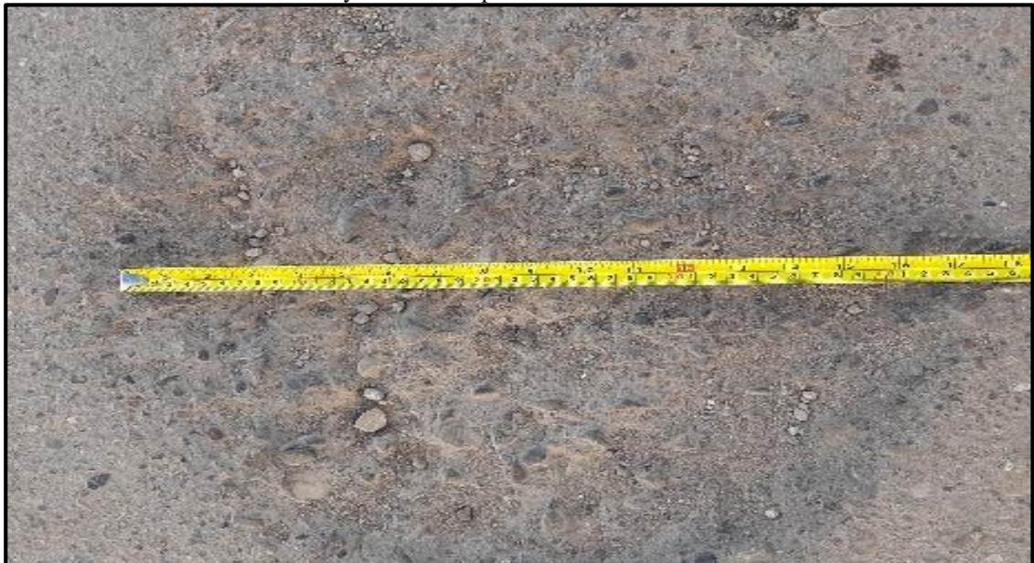
Fotografía 9. Vista de peladura y desprendimientos de gravedad 2, evidenciándose pérdida del ligante bituminoso o del agregado.
