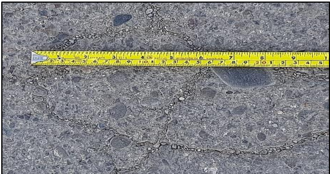
Fotografía 3. Evidencia de piel de cocodrilo de gravedad 2 en la Av. José Olaya, denotándose polígonos incompletos, las fisuras se abren y se observan pérdidas de material en sus bordes.
