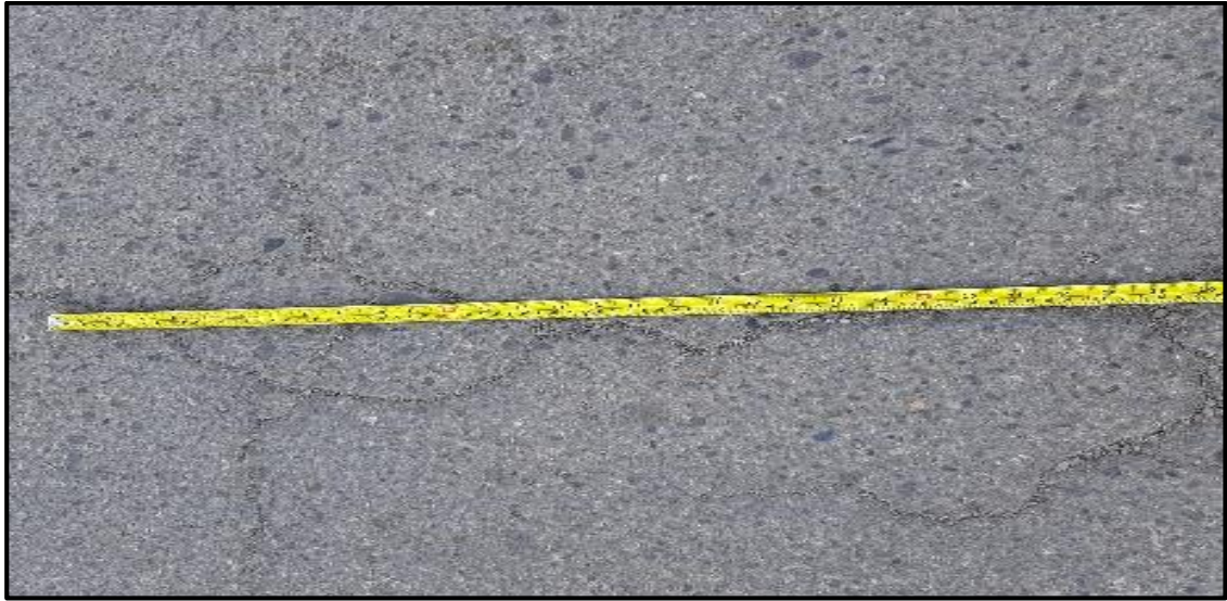
Fotografía 8. Vista de piel de cocodrilo de gravedad 1, donde se evidencia polígonos incompletos, las fisuras se abren y se observan pérdidas de material en sus bordes.
