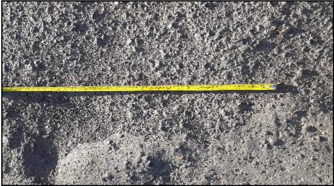
Fotografía 4. Vista de baches Huecos de gravedad 1 en la Av. José Olaya.
