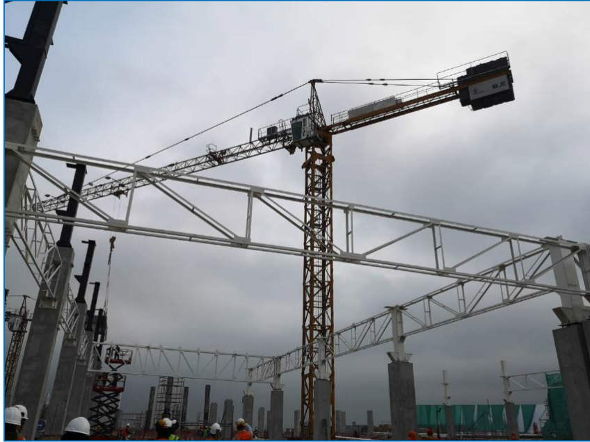
Tijerales para techo metálico – Sector 2C
