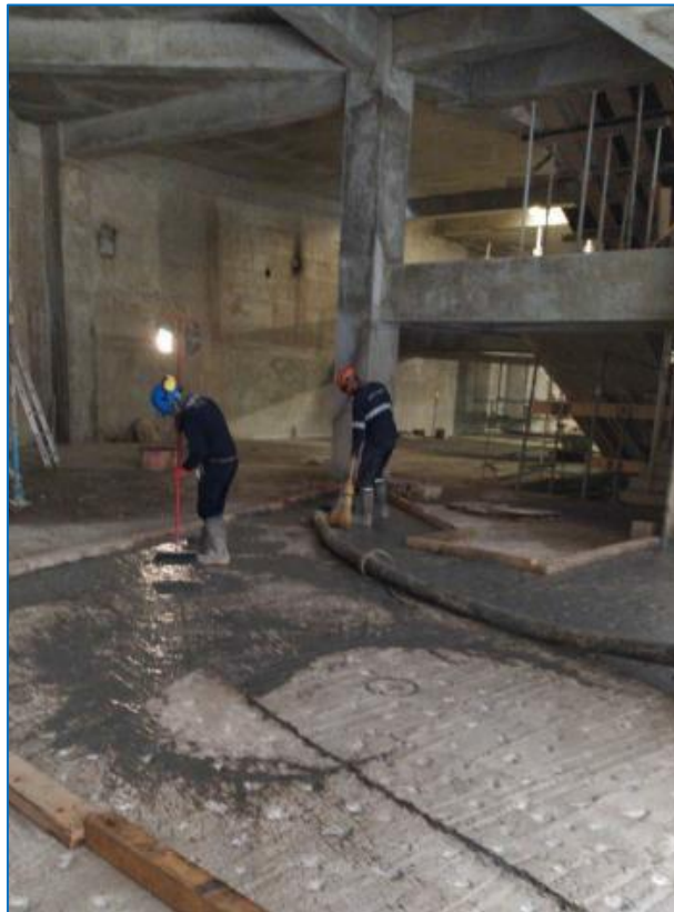
Escarificado de losa y aplicación de Chemawell para vaciado de contrapiso – Sótano 1, Sector 2C
