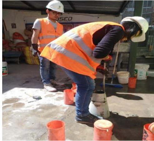
Figura 31. PREPARACIÓN DE ENSAYO DE REVENIMIENTO. En la figura se observa el llenado del cono de abrams.
