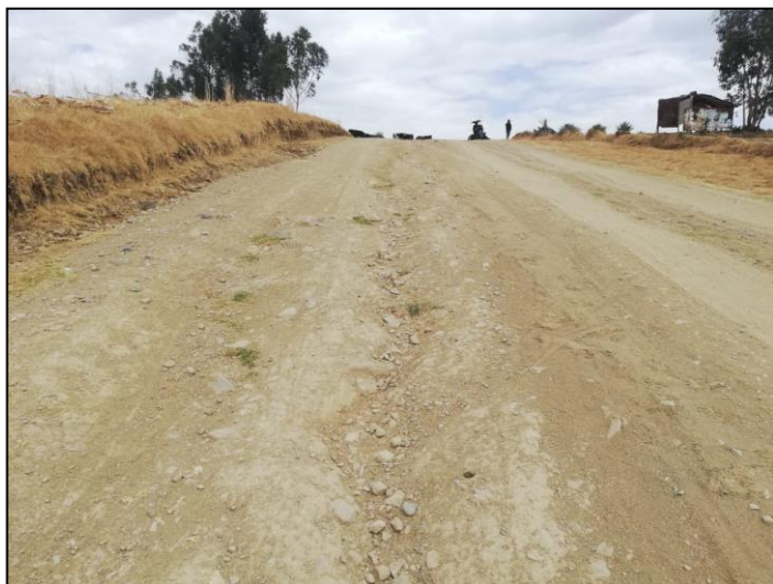
Figura 2. Vista de las fallas de la vía en la zona de estudio.
