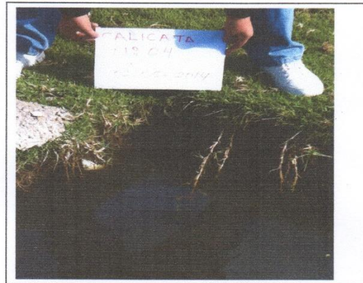
FOTO 06.- C-4, INUNDADA PRODUCTO DE LA FILTRACIONES.
