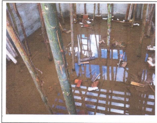
FOTO 03.- INSTALACIONES INUNDADAS PRODUCTO DE LAS FILTRACIONES DE LA NAPA FREATICA.
