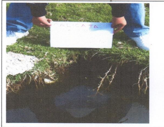
FOTO 01.- EXCAVACION DE C-1, DE 2.50 mts, INSTITUCION EDUCATIVA JORGE BASADRE. SE APRECIA EL AGUA PRODUCTO DE LAS FILTRACIONES DE LA NAPA FREATICA
