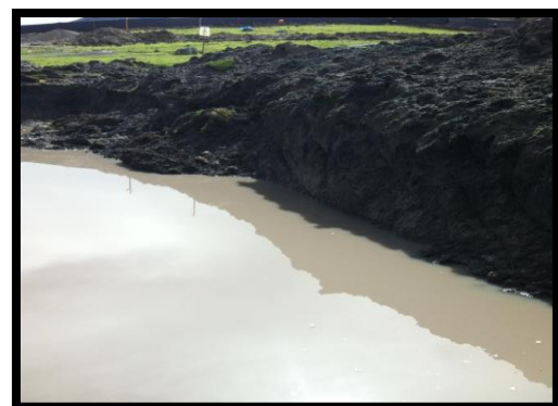
Foto N° 06 realizado la excavación se saturó el terreno.
