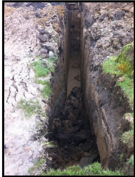
Foto N° 16 Excavación para el dren Se observa filtración de napa freática
