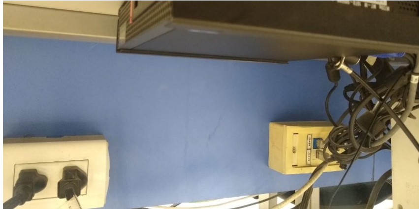
Figura 37 - Ordenamiento de Cableado y separación del circuito eléctrico.
