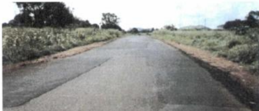
FIGURA 13: Reparación o parchado (Gravedad 2)
