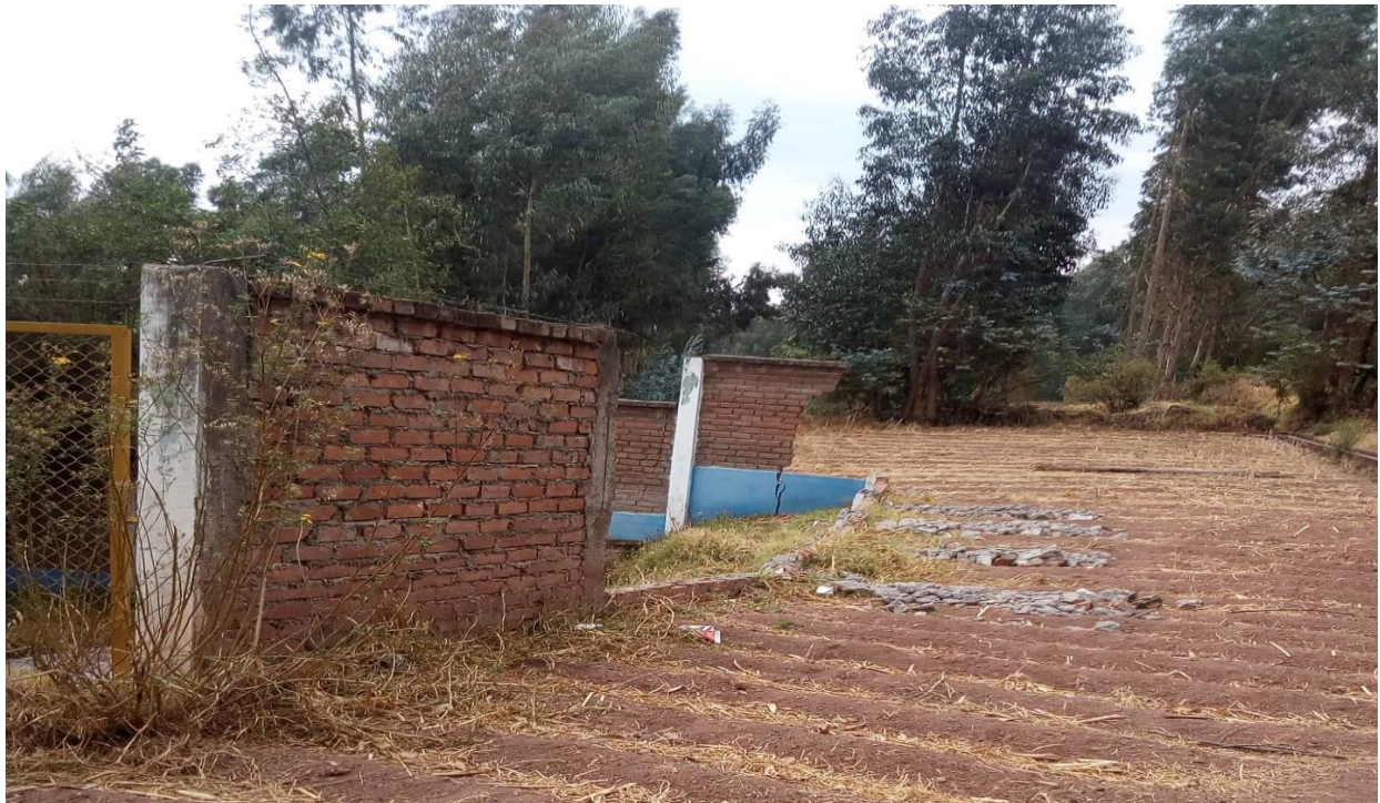
Fotografía N°4: Comprobamos que el cerco perimétrico de la captación se encuentra en mal estado.
