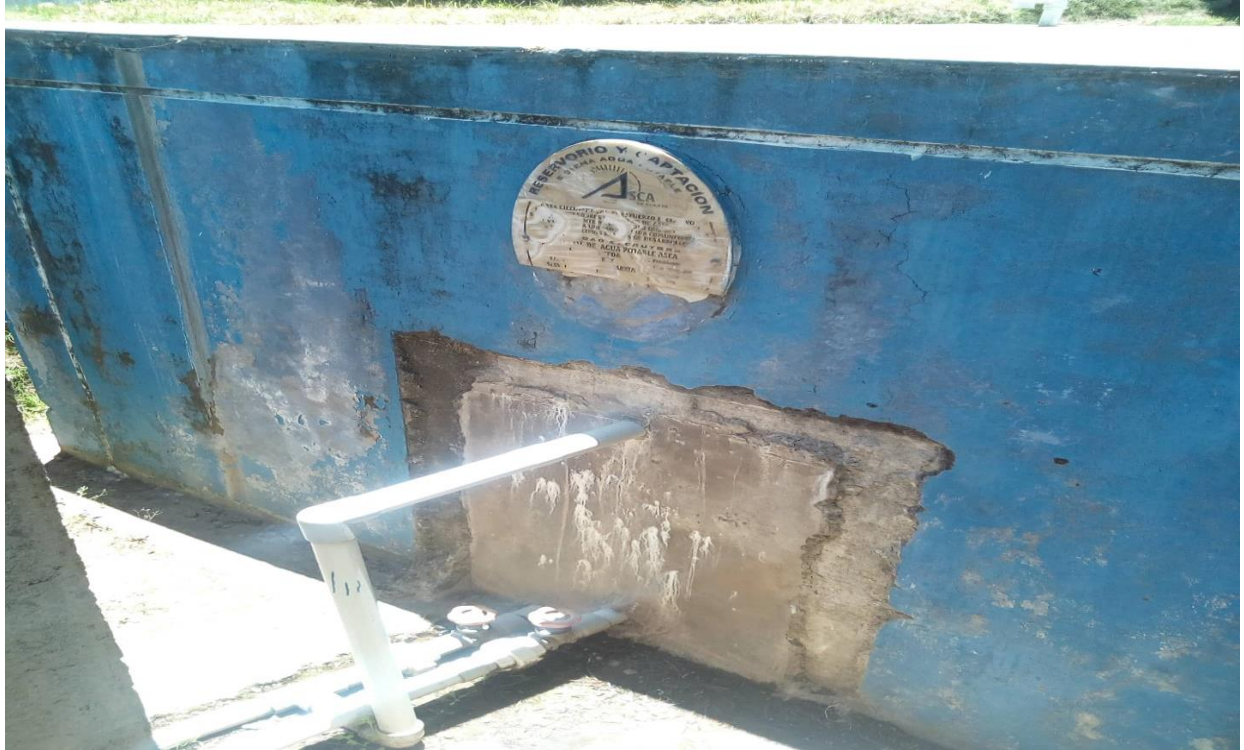
Fotografía N°3: Verificando el mal estado del actual reservorio dentro de la captación.
